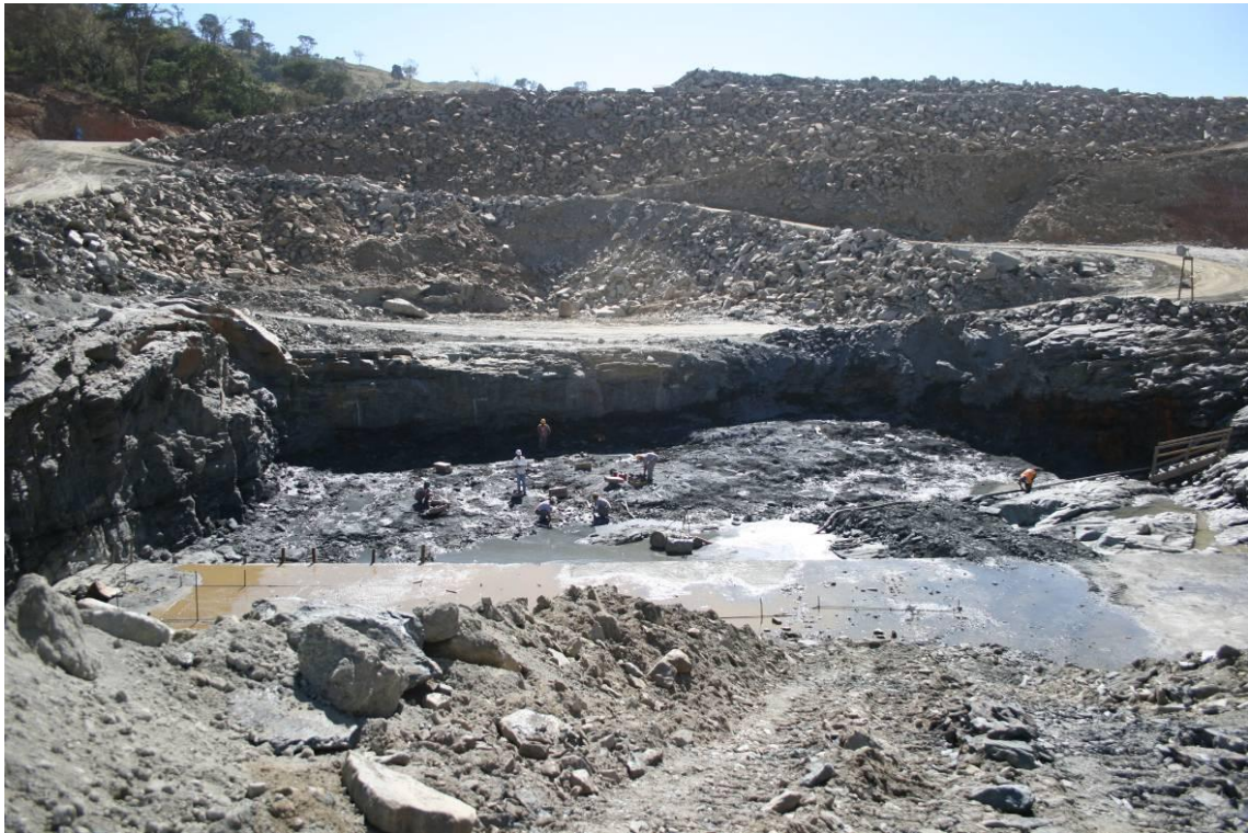
Figura 3-3 – Juntas sub-horizontais de baixa resistência.
