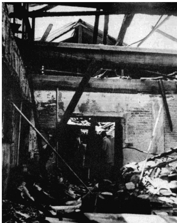
Figura 7 - Cinemateca Brasileira destruída por incêndio
