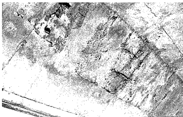
Figura 6.- Armadura expuesta con desplazamiento del hormigón.
