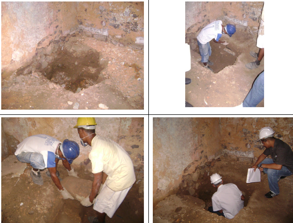
Figura 11: Escavação de fundação para reforço estrutural. Solar da Rua Afonso Pena nº 46 (3ª SR/IPHAN-2010).
