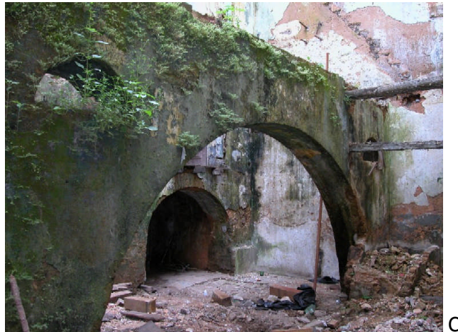
Figura 14: (A) e (B), Conjunto de arcos e Detalhe de arco engastado no pilar, Rua do Giz nº 235 (o autor). (C), ruína de um arco, Rua do Giz nº 295 (o autor).
