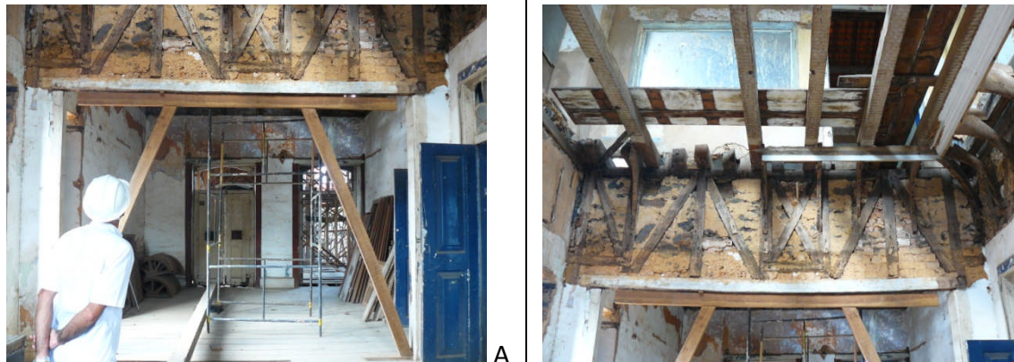
Figura 110: Alteração estrutural. (A) e (B) interrupção das estruturas em Cruz de Santo André para abertura de vãos. Solar nº 46 Rua Afonso Pena. (3ª SR/IPHAN-2010).
