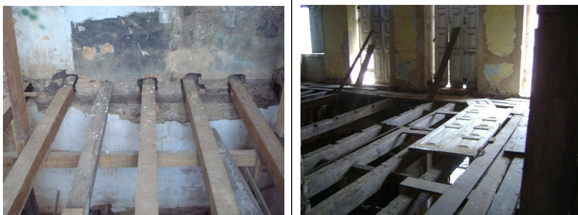
Figura 28: barrotes de madeira (suporte para o assoalho) engastados na parede da fachada. (3ª SR/IPHAN-2010).
