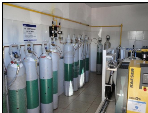
Figura 4.17 - Central de Ar Comprimido da UPA Samambaia/DF. Fonte: Autor (2012).
