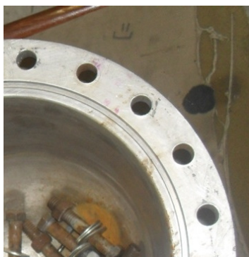
Figura B.2: Rasgo existente no flange do corpo do reator
