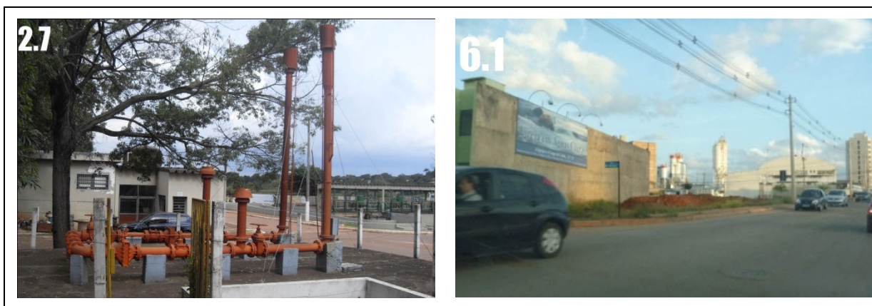
FIGURA 7 – QUEIMADORES DE METANO E DISTRIBUIDORA DE CIMENTO
