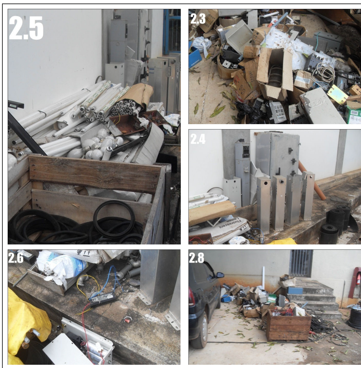
FIGURA 11 – ACÚMULO DE MATERIAL ELÉTRICO Fonte: Voluntário 2.
