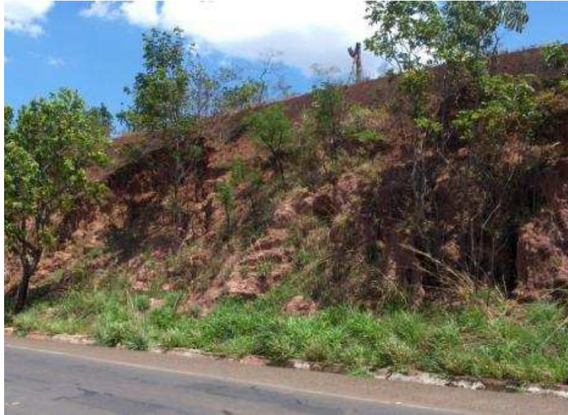
Figura 4.13 - Erosão em arenitos da Formação Botucatu, corte da rodovia BR-060.
