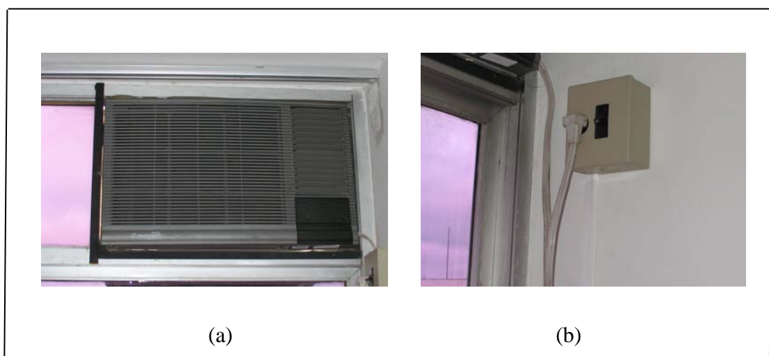
Figura 4.7 Aparelho de refrigeração antigo, não eficiente: (a) aparelho próximo ao teto da sala dificultando a ligação manual e (b) ligação por meio de disjuntor.
