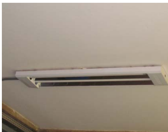
Figura 4.5 Luminárias que atendem aos requisitos de segurança e de eficiência energética.
