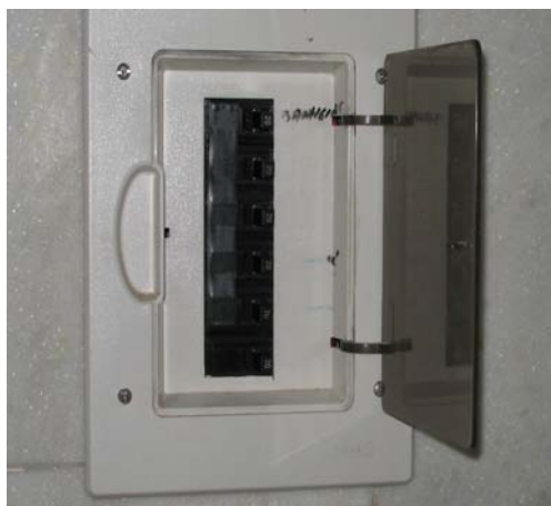
Fig.4.2 – Quadro de distribuição de energia elétrica do andar.
