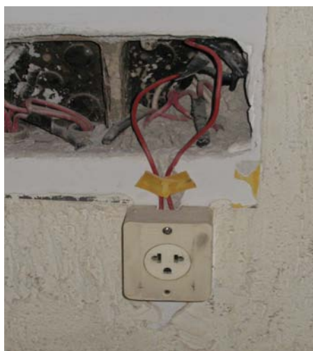
Fig. 4.1 – Ilustração de fiação exposta nos corredores da organização.
