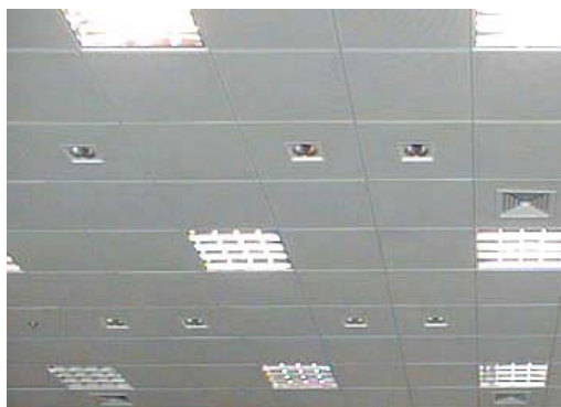
Figura A-3 – Luminárias com 4 lâmpadas em forro modulado (Refax, 2009)
