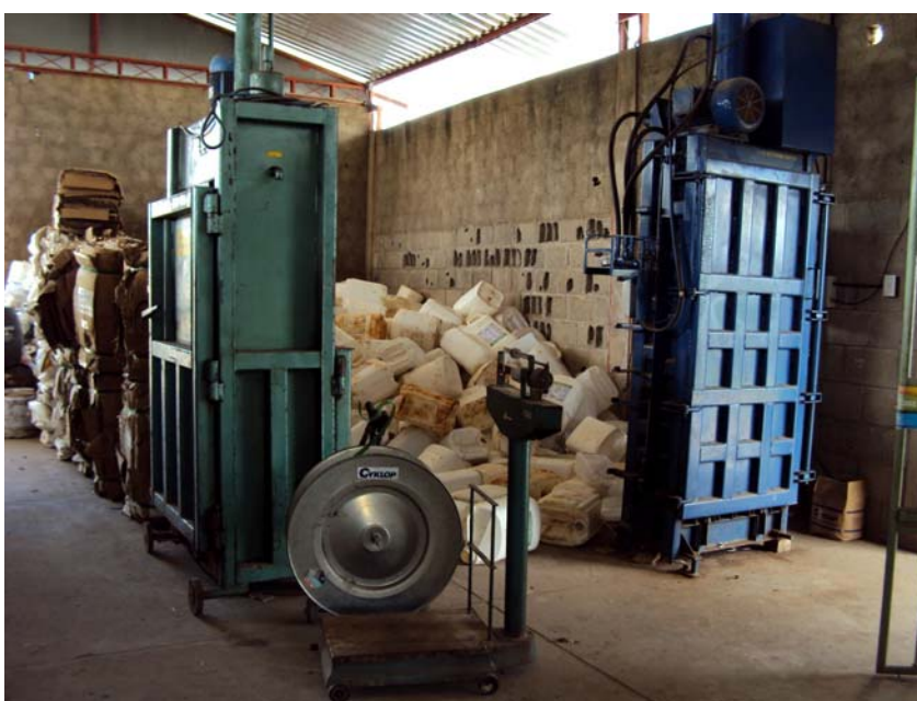
Fotografia 2 – Vista interna da Central de Recolhimento de Embalagens Vazias de Agrotóxicos da Associação dos Revendedores dos Produtos Agropecuários do Nordeste Arpan, Carpina - PE. Autor: José Luís Said Cometti Data da foto: 2009
