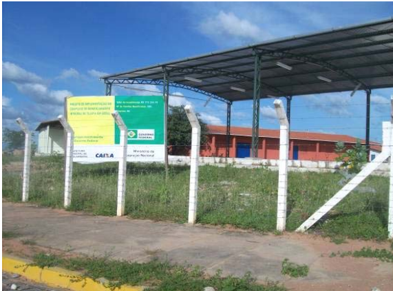
Fig. 66. Complexo de Beneficiamento Integral da Tilápia em Nova Jaguaribara – CE. Fonte: Acervo do autor, 2009.
