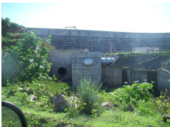
Figura 35. Dutos para aproveitamento do potencial hidrelétrico no Castanhão – CE. Fonte: Acervo do autor.
