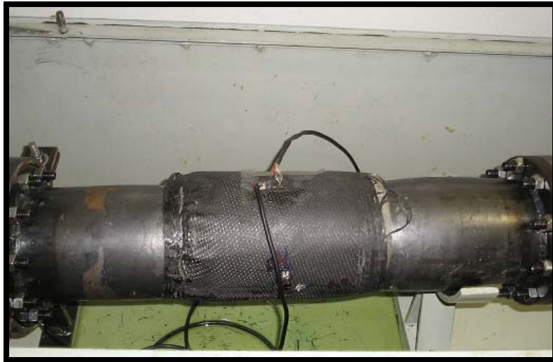
Figura 5.42: Tubo reparado já rompido e deformado plasticamente.
