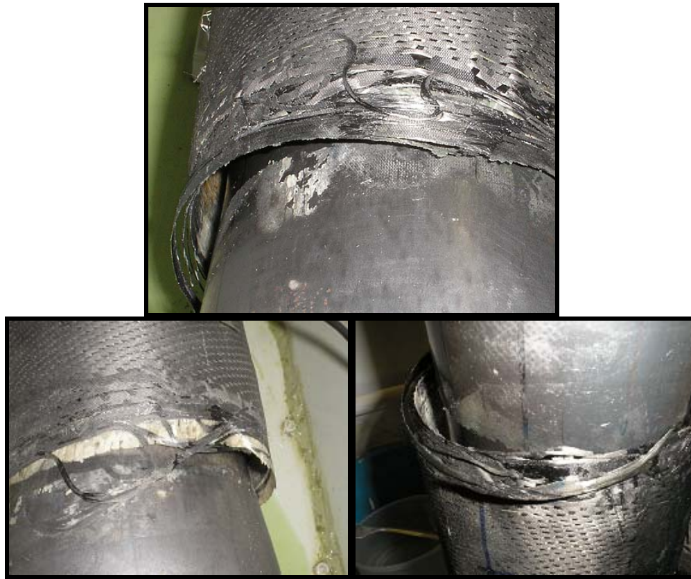
Figura 5.45: Delaminação do reparo de material compósito.
