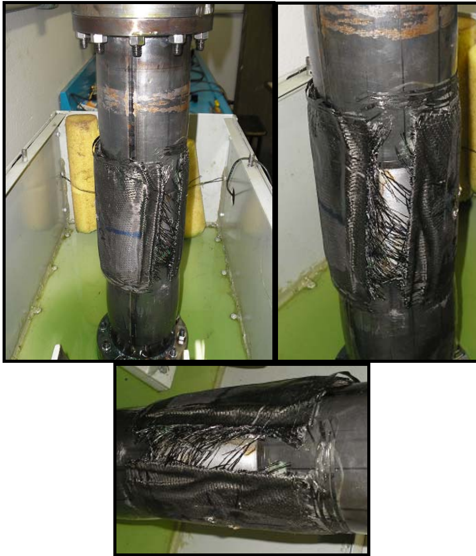
Figura 5.47: Ruptura longitudinal do reparo de material compósito.
