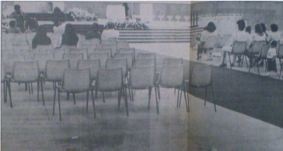
Figura 76 - A diferença entre as primeiras filas com bancos projetados e as demais cadeiras Fonte: Goteiras deixam Catedral inundada durante as chuvas. Correio Braziliense, Brasília, 10 fev. 1992.
