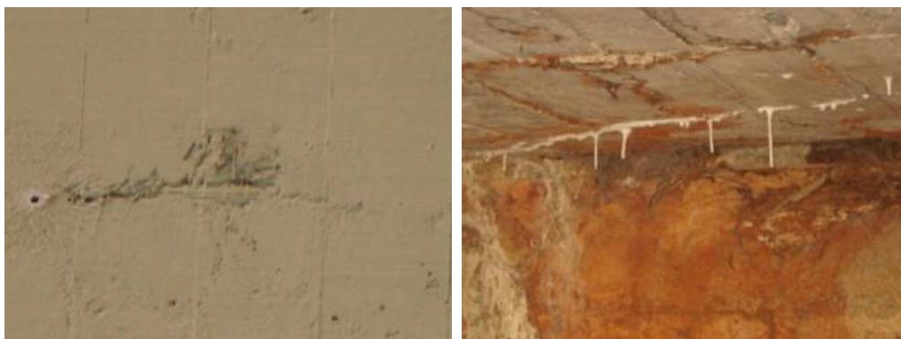
a) Laje de cobertura – Vão norte. Cobrimento deficiente - F_i = 2
