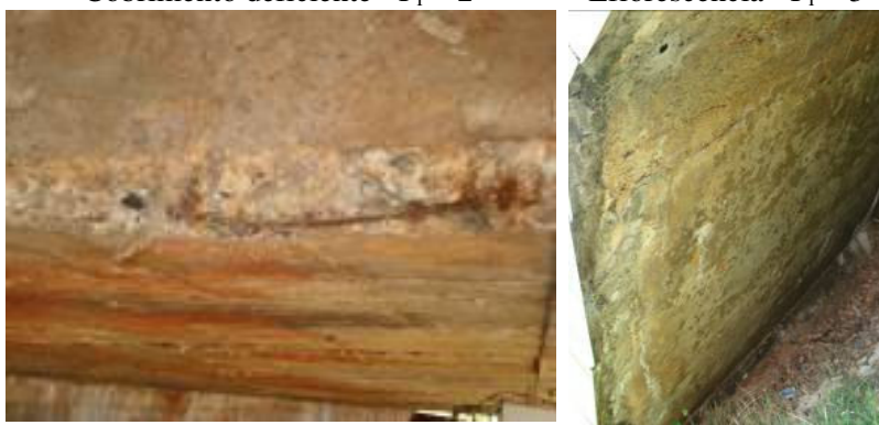
c) Laje do piso – Vão norte. Cobrimento deficiente - F_i = 2 Corrosão - F_i = 2
