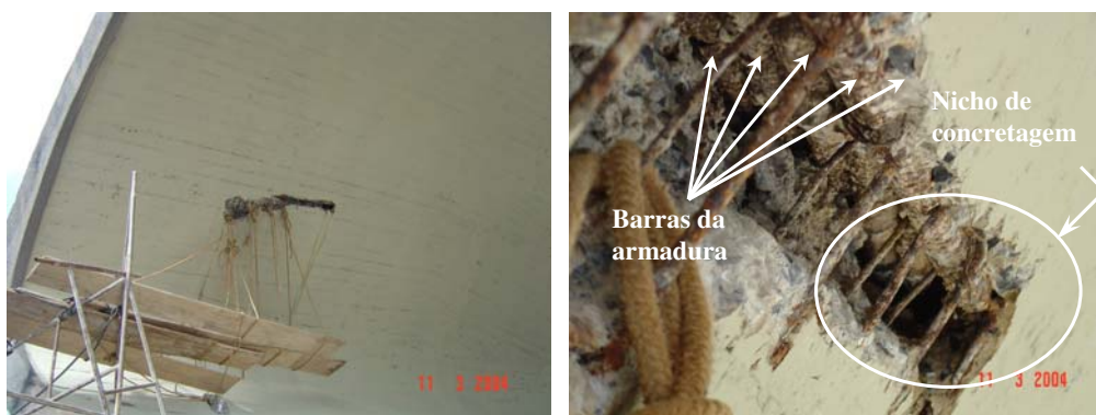
a) Corte executado na superfície interna b) Nicho de concretagem e barras da armadura passiva
