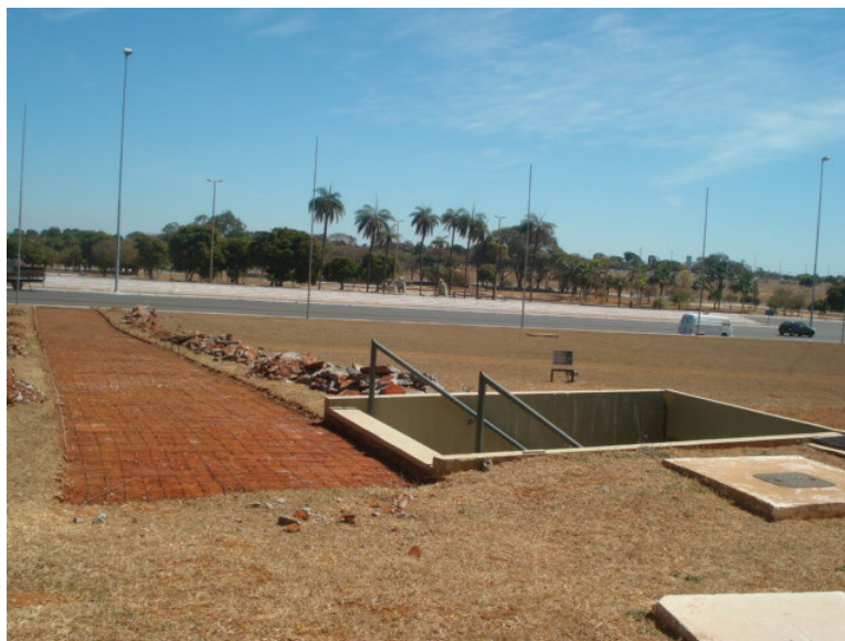
Figura 4.11 - Passarela de ligação da Avenida do Exército e o túnel do Teatro Pedro Calmon (Fonte: Autor).
