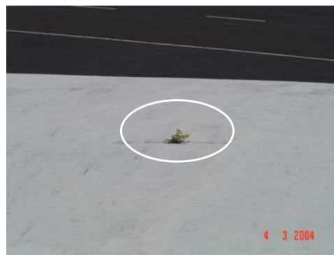
Figura 3.16 – Trinca na superfície externa do monumento com vegetação brotando (Fonte: Relatório técnico nº10/2004 da CRO-11).
