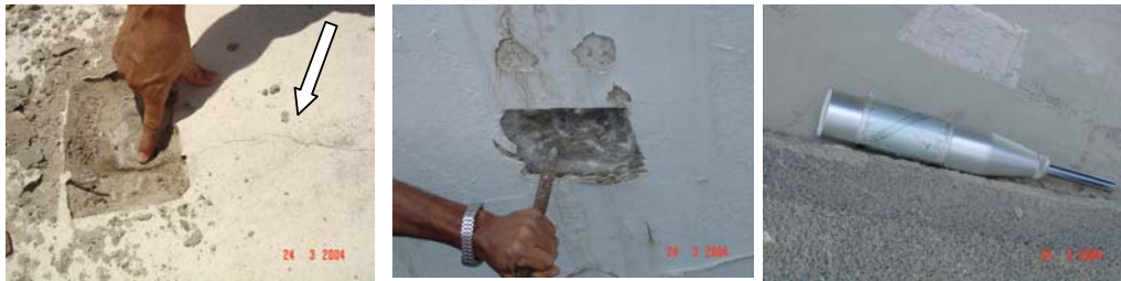
a) Corte 1 - A seta indica trinca na estrutura. b) Corte 2 em execução. c) Esclerômetro utilizado na obtenção da resistência mecânica do concreto.
