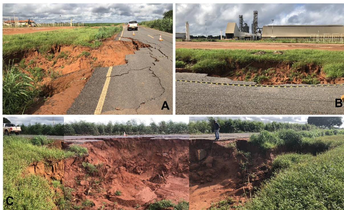
Figura 5.11. Abatimentos de solos ocorridos em março de 2021 comprometendo parcialmente a Rodovia BA-225 por uma extensão de 14 metros em frente a Cargill (E428095.52 m e N 8832314.99 m) situada a 4,4 km do povoado do Coaceral.
