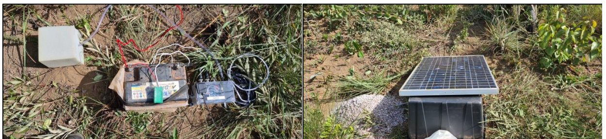
Figura 2.15 – Instalação típica de um dos elementos temporários. À esquerda, RS&Boom conectado à bateria e ao filtro. À direita, caixa de proteção para os equipamentos, camada de brita que cobriu o filtro e o painel solar.
