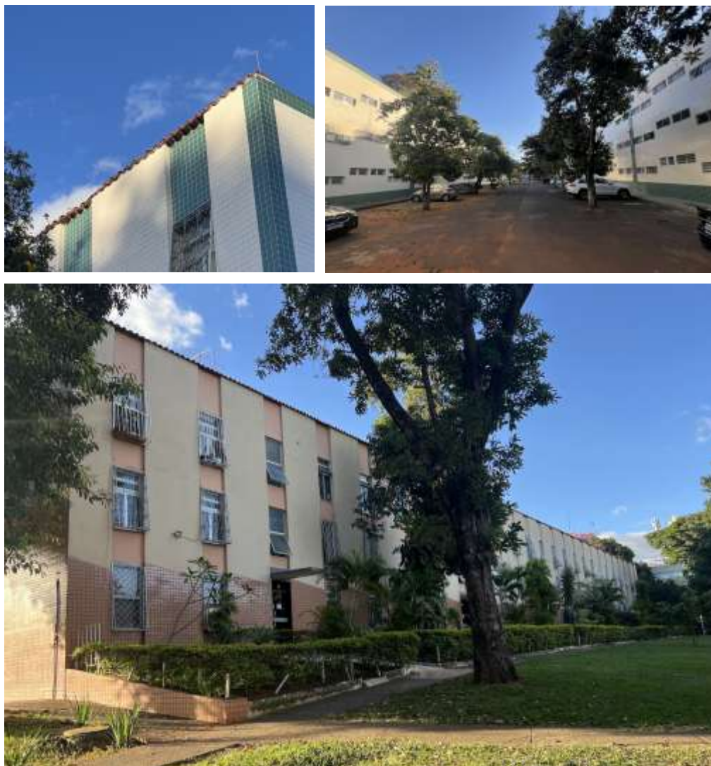
Figura 10 – Condições atuais dos Blocos JK.
