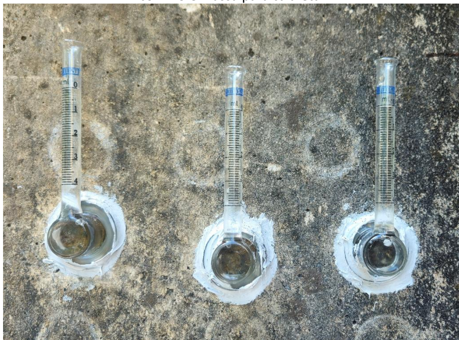
Figura 67 – Imagem da parede do RU, com sujidade: realização do ensaio com tubos Karsten fixados com PU e massa para calafetar.
