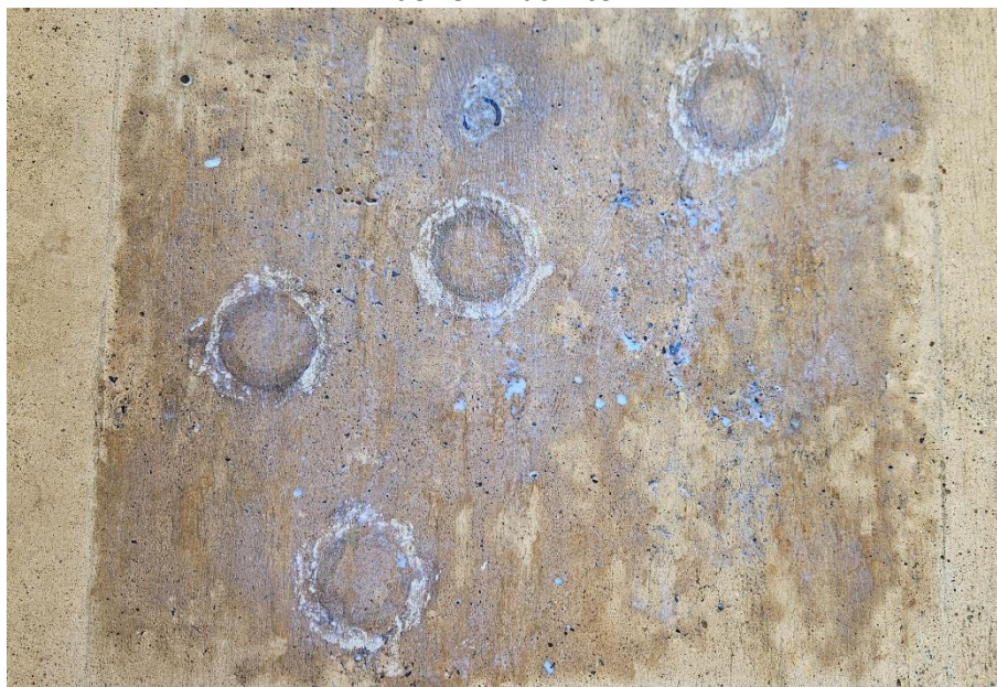
Figura 76 – Área 01 de ensaio de absorção de água com tubos Karsten 10 minutos após a aplicação de verniz acrílico.
