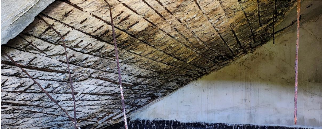
Figura 36 – Laje da caixa d'água com deslocamento e armaduras em estado avançado de corrosão.
