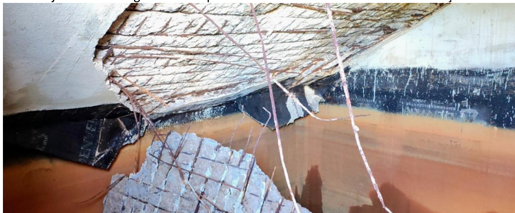
Figura 35 – Laje da caixa d'água com deslocamento e armaduras em estado avançado de corrosão.
