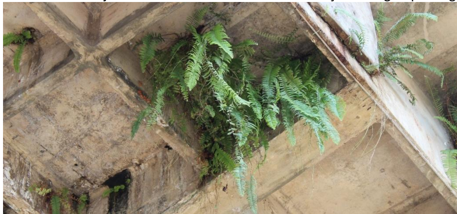
Figura 14 – Fundo de laje nervurada com manchas e colonização biológica por vegetação.
