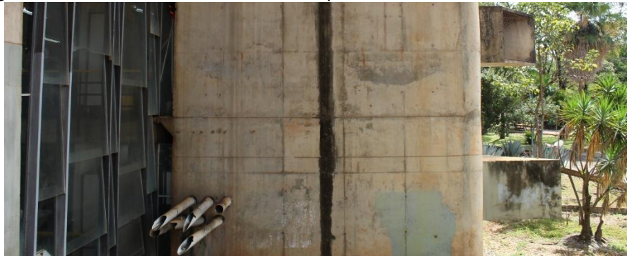
Figura 15 – Parede externa em concreto aparente com manchas de escoamento.
