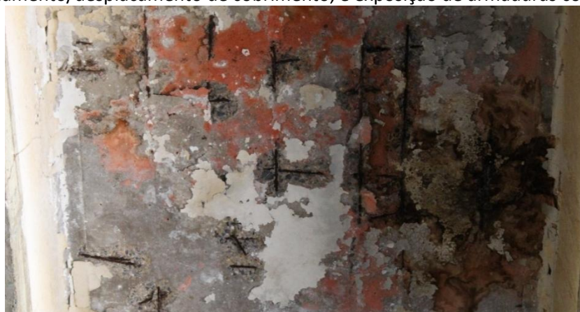
Figura 13 – Fundo de laje nervurada no interior do RU/UnB com fissuras, manchas de ferrugem, destacamento/desplacamento de cobrimento, e exposição de armaduras corroídas.
