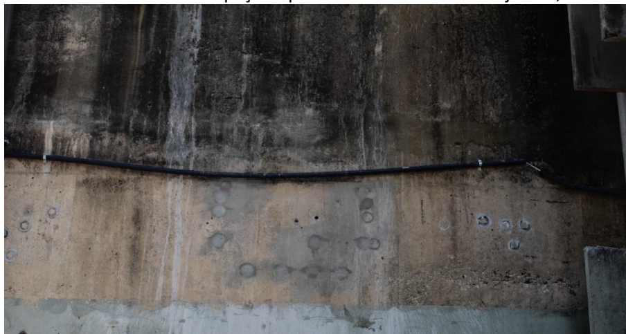
Figura 16 – Face externa da parede da torre anexa ao RU/UnB: presença de manchas causadas por eflorescências - escoamento esbranquiçado por acúmulo de sais – e sujeira, de cor mais escura.
