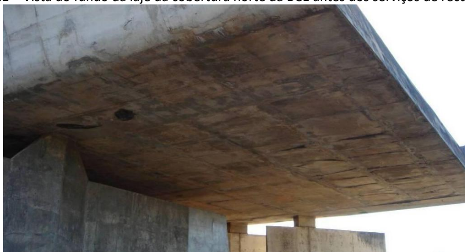
Figura 21 – Vista do fundo da laje da cobertura norte da BCE antes dos serviços de recuperação.
