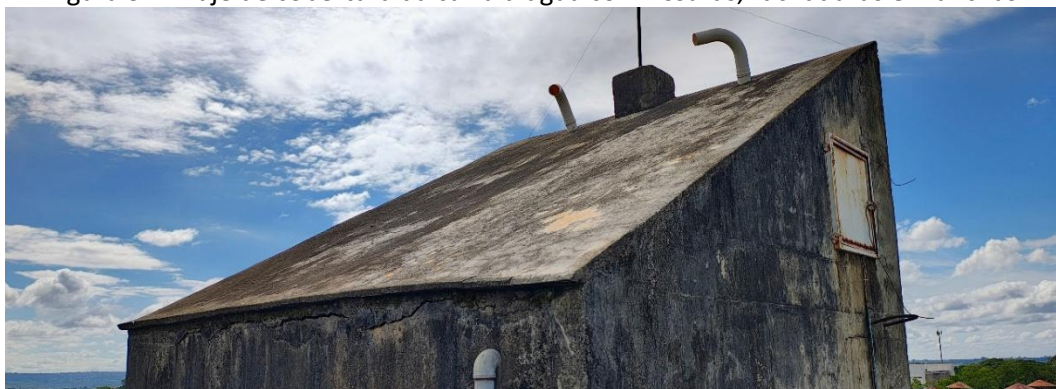
Figura 34 – Laje de cobertura da caixa d'água com fissuras, rachaduras e manchas.
