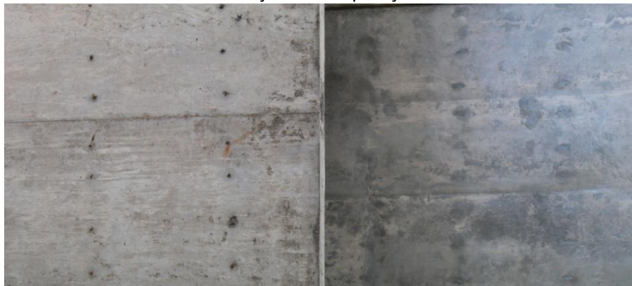
Figura 8 – Marcas dos painéis de formas e amarração nos brises da BCE/UnB: antes e depois dos serviços de recuperação.
