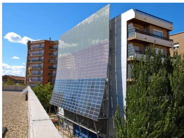
Figura 3: Fachada com sistemas fotovoltaicos integrados às edificações (BIPV).
