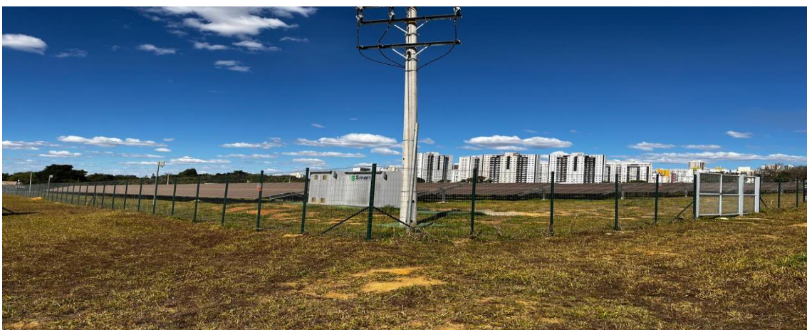
FIGURA 16 - Usina fotovoltaica de solo – 720kwp no PEAC
