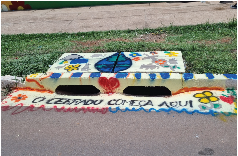
Figura 94: Intervenção com mensagem sobre educação ambiental em uma boca de lobo do Sol Nascente
