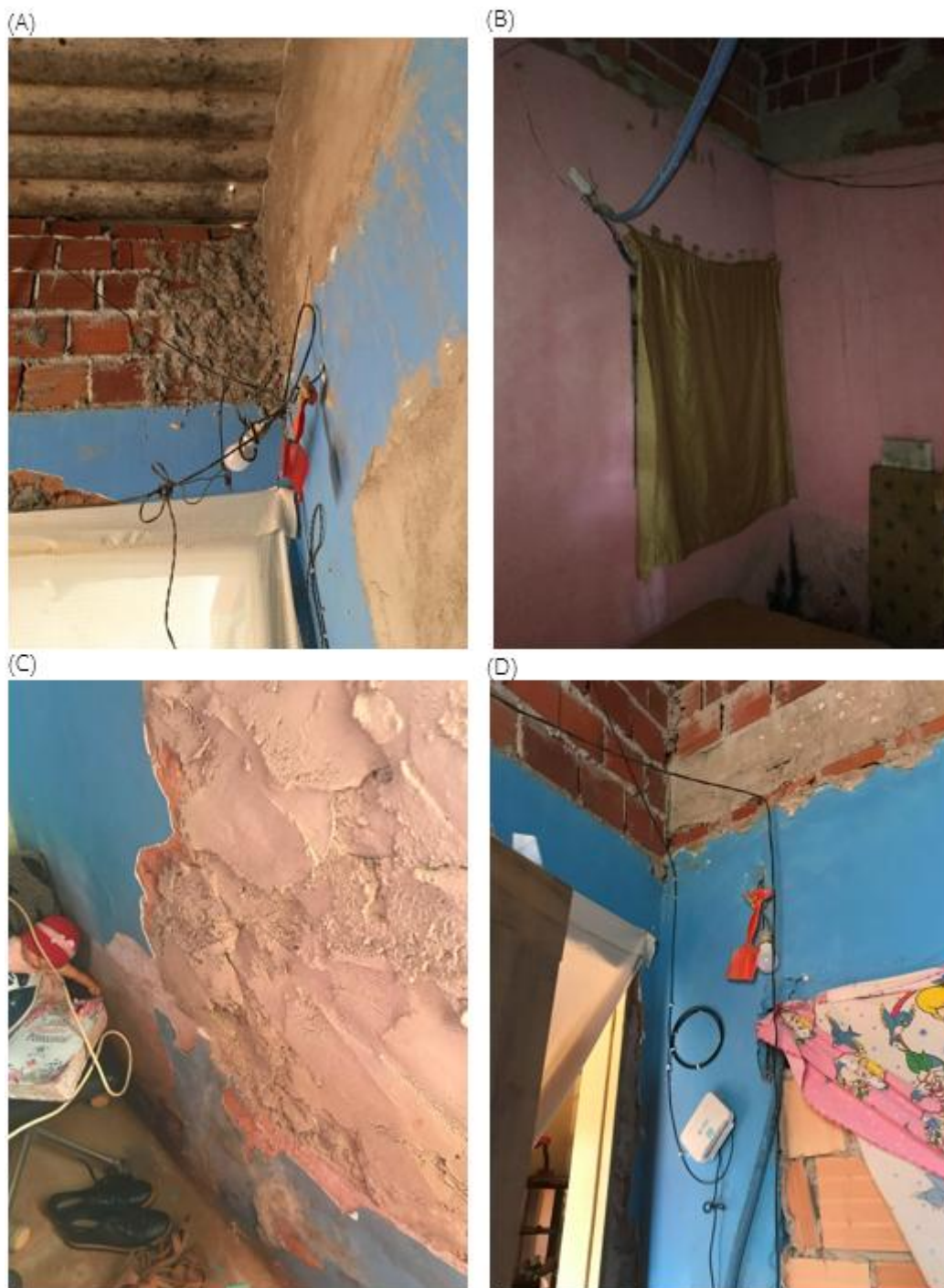
Figura 44: Registros fotográficos da habitação Vanessa antes das intervenções – inadequações dos quartos.
