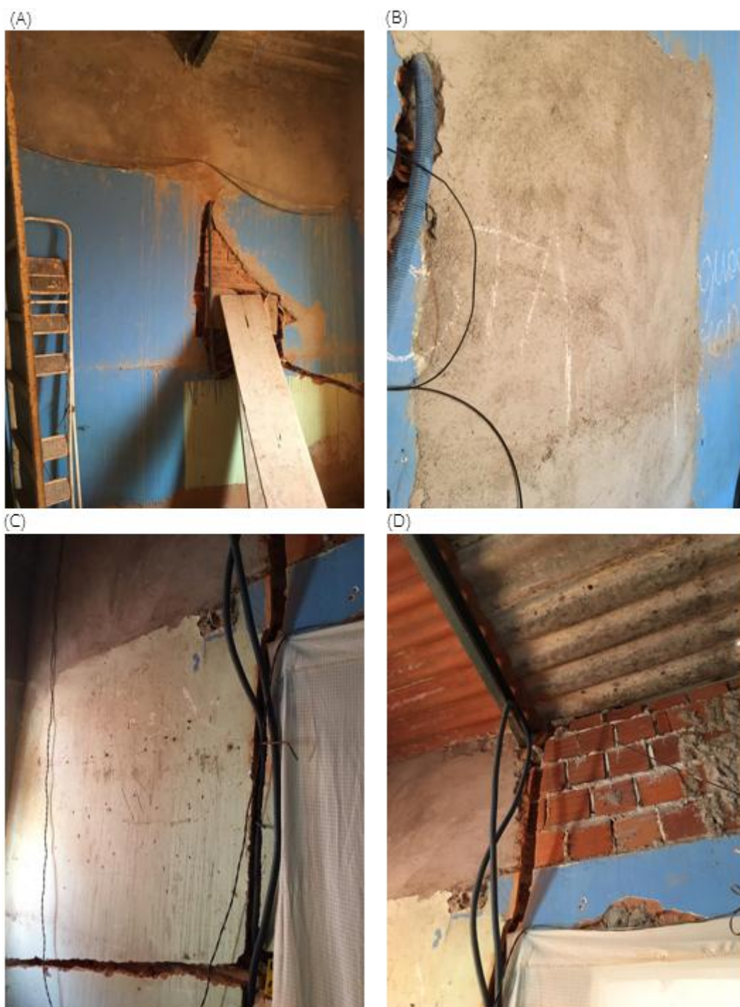
Figura 45: Registros fotográficos da habitação Vanessa antes das intervenções – inadequações dos quartos.
