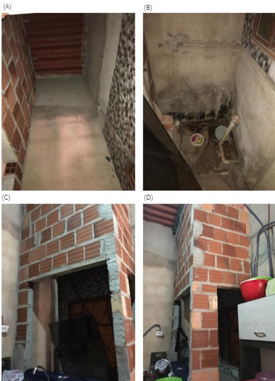
Figura 42: Registros fotográficos da habitação Vanessa antes das intervenções – poço de ventilação.
