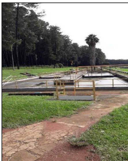
Figura 7- Reator Anaeróbio do tipo UASB da ETE-Paranoá Fonte: Autor
