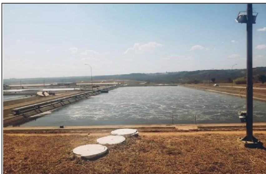
Figura 4- Reatores Aerados Difusos da ETE-Melchior, fase de aeração
