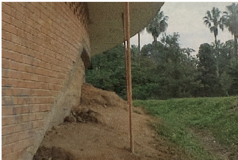
Figura 56 – Talude descaracterizado na lateral das fachadas do Auditório. Fonte: EPAHC, 2002.
