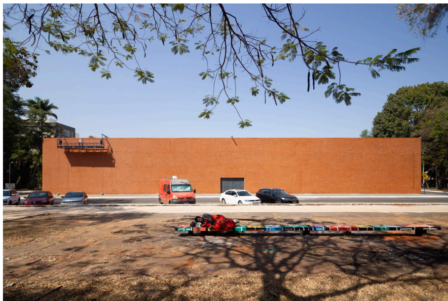
Figura 32 – Fachada Noroeste (perspectiva a partir do lote B da EQS 106/107), com porta que foi adicionada posteriormente na fachada, diferindo do projeto original. Fonte: Marina Lira, 2024.
