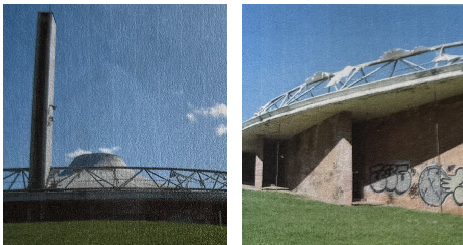
Figura 59 – Fachadas do edifício, onde é possível ver parte da treliça de cobertura exposta devido ao rompimento da lona, além das paredes pichadas. Fonte: Acervo prof. Sérgio Marques, 2009.
