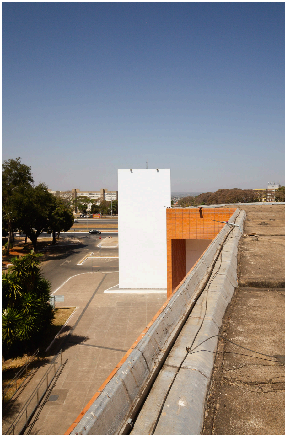
Figura 42 – Lateral impermeabilizada da cobertura do Cine Brasília, com passagem de cabos do sistema de proteção contra descargas atmosféricas. Ao fundo, a torre de refrigeração. Fonte: Marina Lira, 2024.
