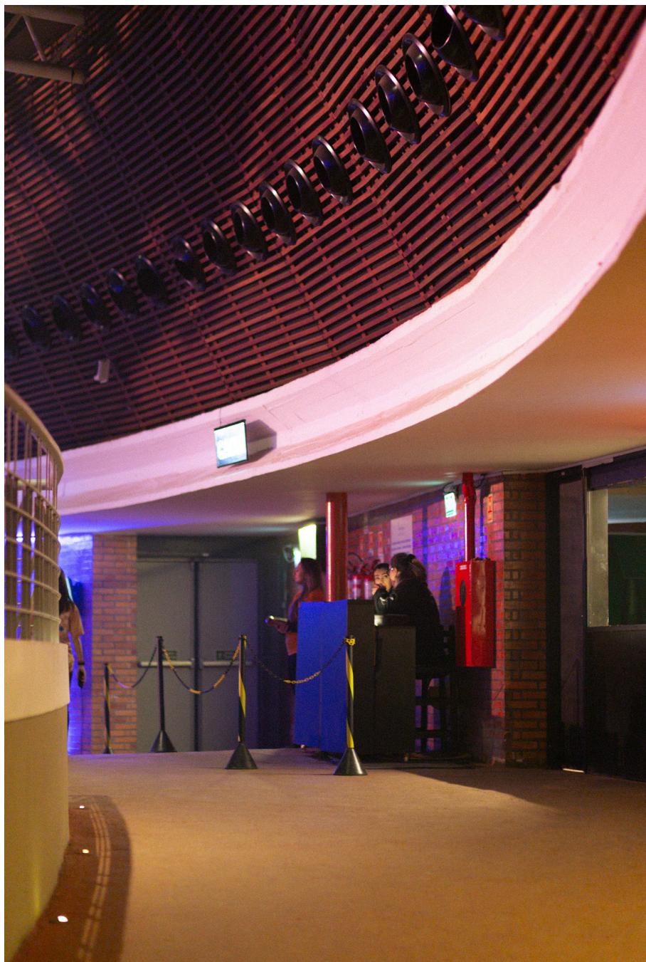
Figura 76 – Interior do Auditório Araújo Vianna, com destaque para o encontro entre a laje – original do projeto de 1964 – e a nova cobertura com tratamento acústico. Ao fundo, uma porta que fecha as paredes em planos que circundam o edifício. Fonte: Marina Lira, 2024.
