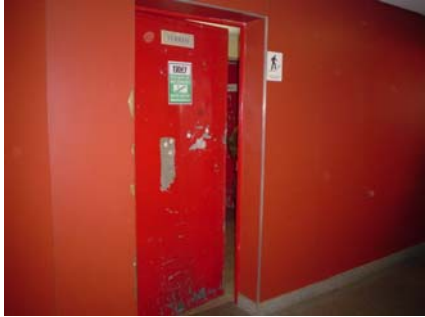
Foto 33 – Má conservação das portas das escadas de emergências
