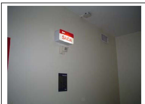
Foto 20 – Sinalização e iluminação de emergência dentro da escada.
