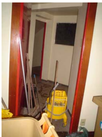
Figura 35 – Água na caixa de escada de emergência
