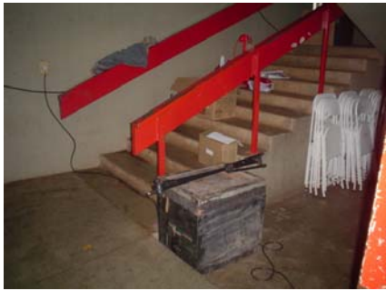
Foto 5 – A escada de emergência servindo de depósito.
