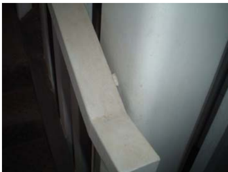
Foto 12 – Vista superior do corrimão (não há como colocar a mão devido a proximidade com a estrutura metálica)
