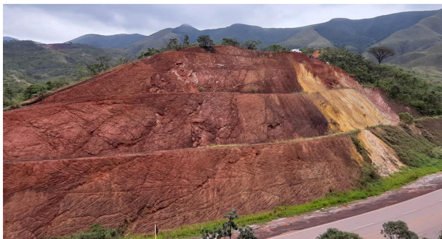
Figura 3.4 - Vista geral do talude MA03, evidenciando as diferenças cromáticas e zonas de erosão associadas a variações de intemperismo no solo residual de filito.
