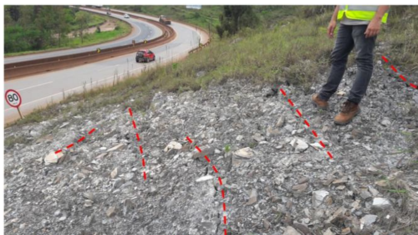
Figura 3.7 - Trincas sucessivas remontantes ao longo do talude favorecem a infiltração de água, induzindo o aumento de poro-pressões nos poros e conseqüente movimentação (Fonte: Adaptado de Silva; Costa; Ehrlich, 2018).
