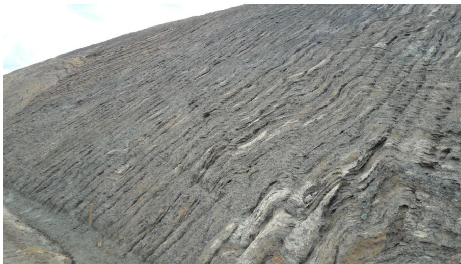
Figura 2.4 - Processos erosivos na face do talude de corte localizado na BR-040 no QF.
