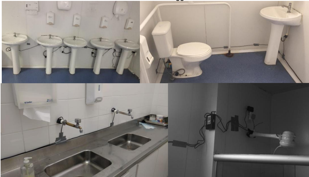
Figura 3. Equipamentos de medição de fluxo instalados em aparelhos sanitários, conectados a módulos data logger
