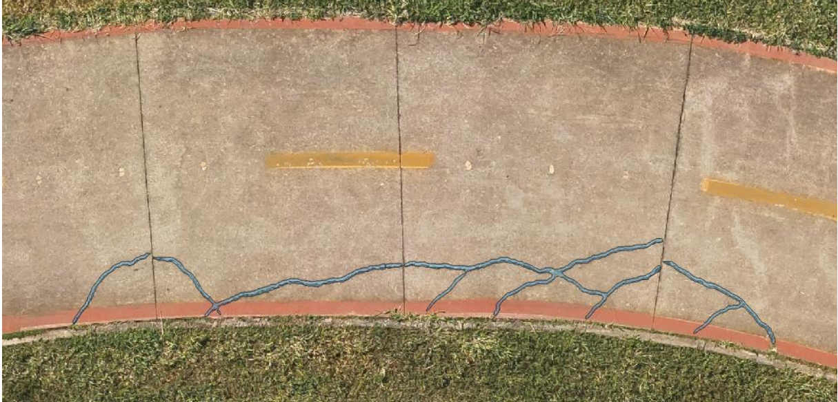
Figura 20 – Resultado da vetorização após ajuste, com preservação do contorno real das fissuras segmentadas.
