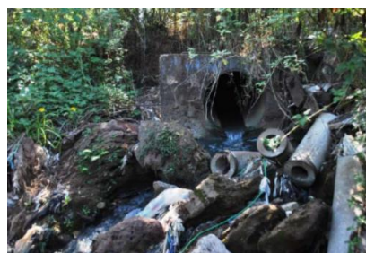
Foto 9. Lançamento de drenagem pluvial precário em curso hídrico à jusante da ARIS (cód.PS).Foto extraída de parecer de analista do IBRAM.
