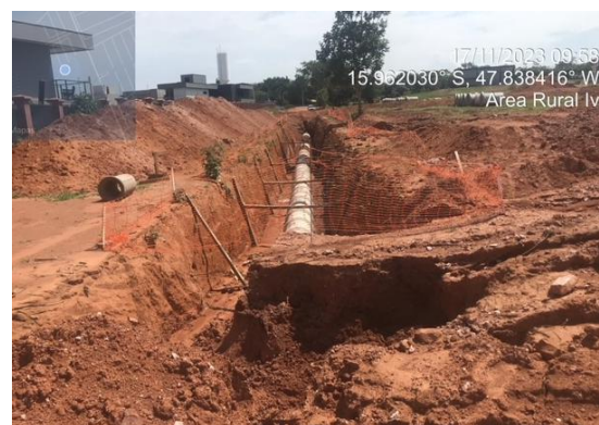
Foto 4. Obra de drenagem pluvial convencional em implantação sem a devida licença ambiental em novo condomínio de alta renda. O responsável foi autuado pela irregularidade pelos auditores fiscais.
