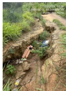
Foto 6. Processo erosivo em área a jusante de ARINE, indicando escoamento pluvial irregular carregando lixo de áreas ocupadas irregularmente a montante.
