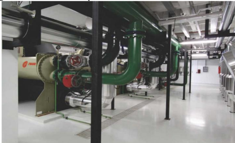
Figura 6 - Data Center da empresa X – Ambiente interno – Chiller centrífugo.
