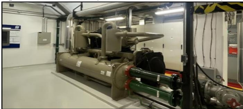
Figura 8 - Data Center da empresa X – Ambiente interno – Chiller parafuso
