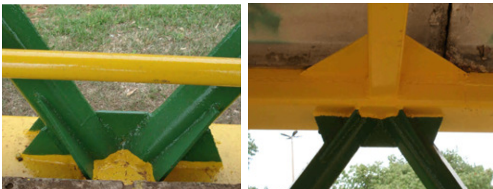
Figura 4.6 – Detalhes dos enrijecedores do piso a esquerda e da cobertura a direita, da passarela sobre a E.P.I.A
