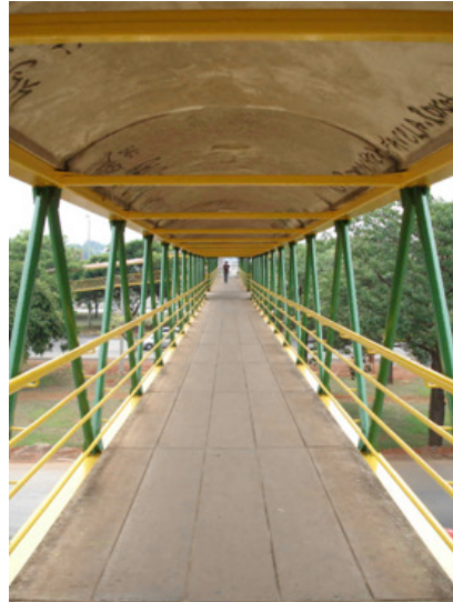
Figura 4.5 – Vista do vão horizontal com detalhes do corrimão e guarda-corpo da passarela sobre a E.P.I.A.
