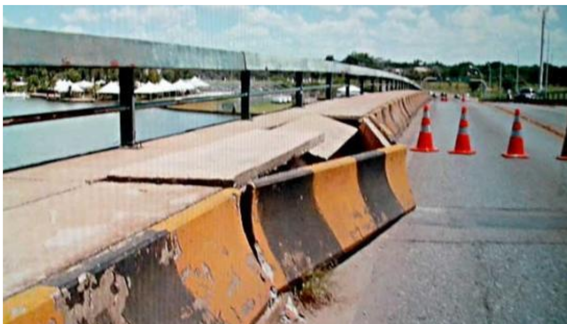
Figura 34 – Deslocamento do guarda-rodas para o interior da pista, em 5 de janeiro de 2014
