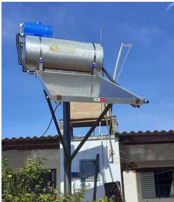
Figura 69 - Placa de aquecimento solar e boiler instalados sobre torre pela Cemig.
