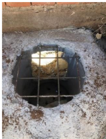
Figura 14 - Bueiro na divisa entre Dorothy Stang e Novo Loteamento
