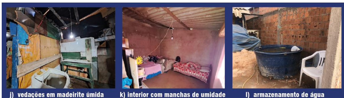
Figura 44 - Presença de umidade e armazenamento de água
