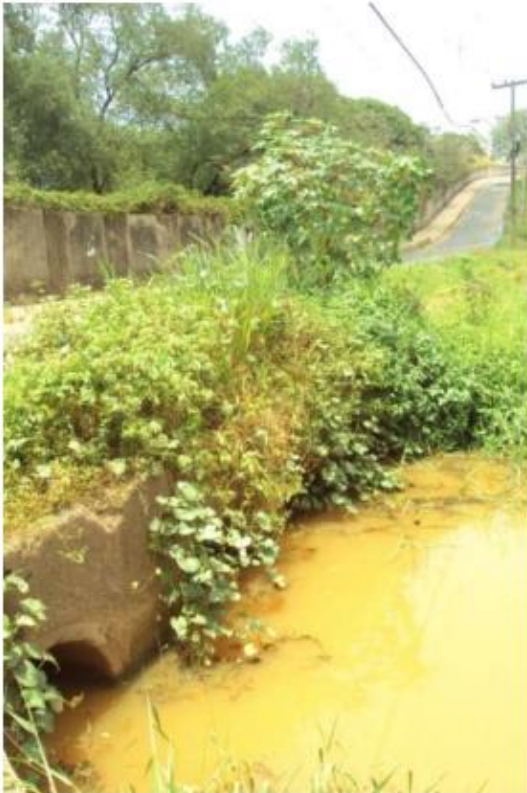
Figura 20. Sistema de drenagem urbana obstruído na Bacia Hidrográfica do Bacanga
