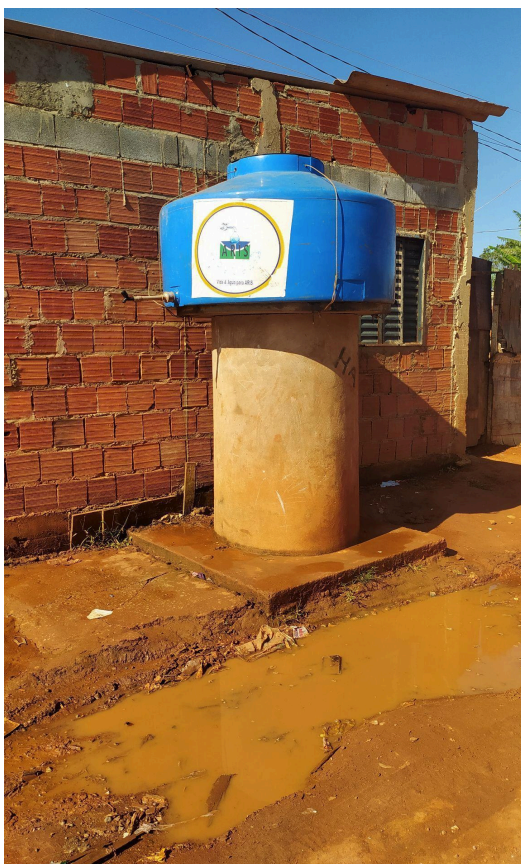
Figura 20 - Reservatório Projeto Vida e Água para ARIS
