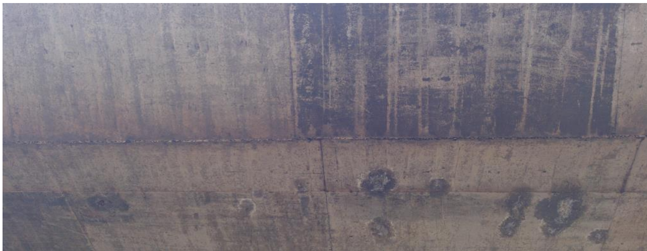
Figura 45 - Relatório 100: Laje do tabuleiro com fissuras
