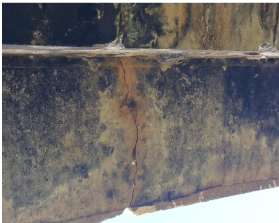
Figura 42 - Laje do tabuleiro com fissura e concreto disgregado
