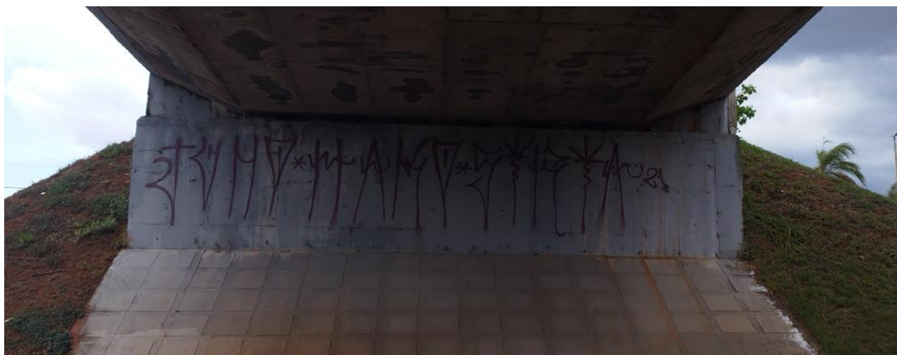
Figura 47 - Relatório 100: Cortina com manchas de umidade
