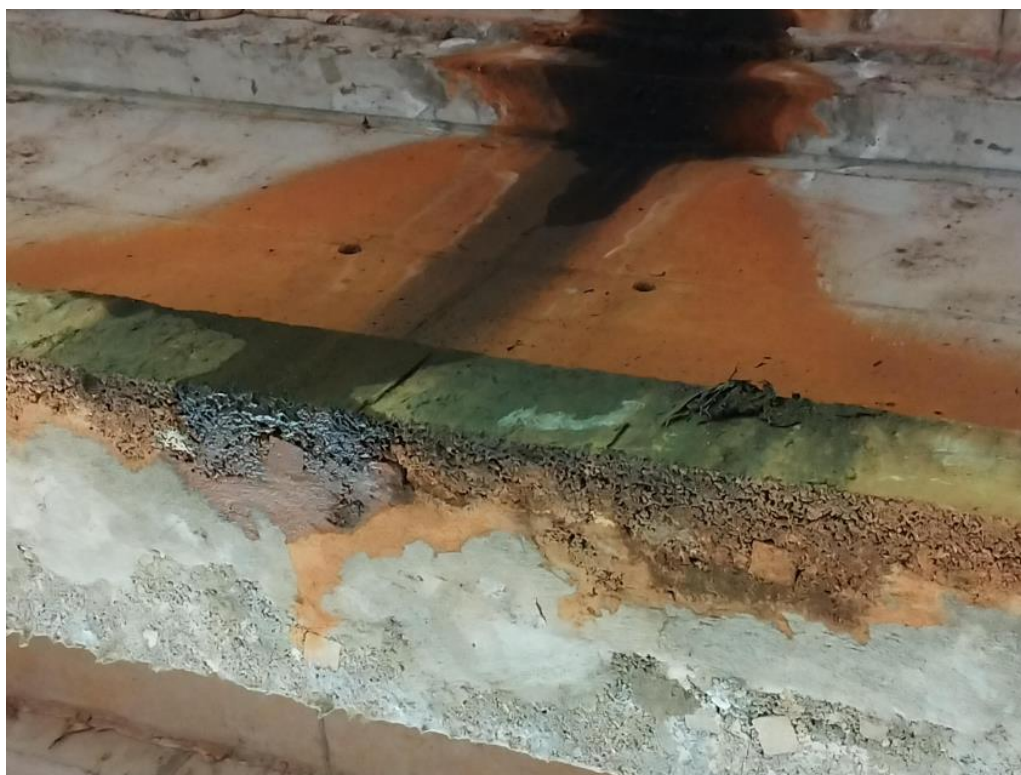
Figura 22 - Relatório 001: Viga longarina 5
