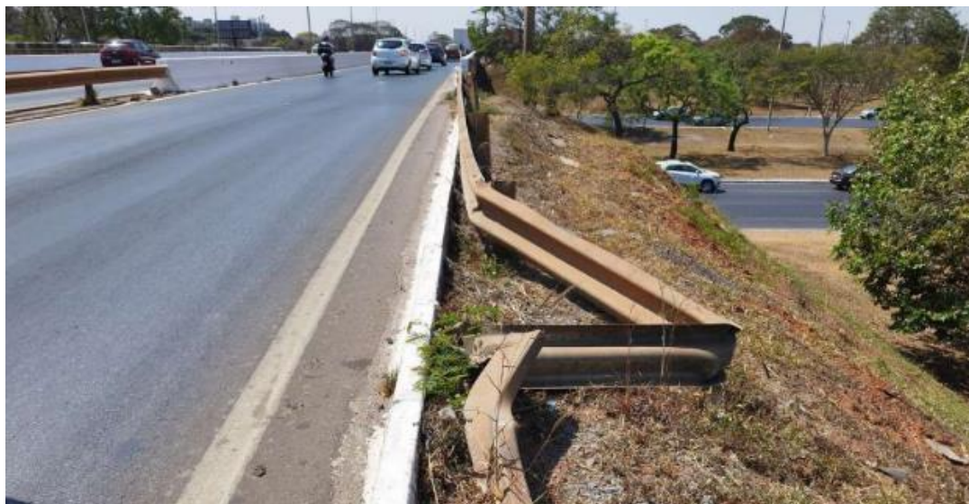
Figura 33 - Relatório 019: defesa metálica
