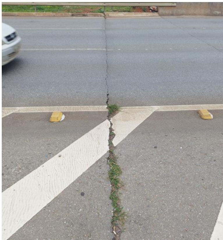
Figura 58 - Relatório 632: Laje de transição com fissuras e vegetação
