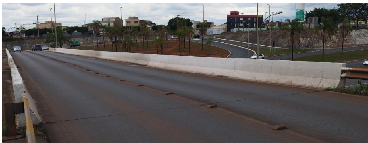
Figura 46 - Relatório 100: Guarda rodas com ausência do dispositivo refletivo
