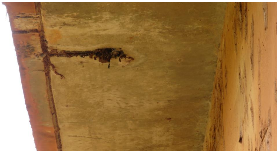
Figura 51 - Relatório 200: Laje do tabuleiro com Concreto disgregado e armadura exposta
