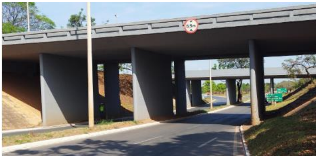
Figura 25 - Relatório 004: Pilares 3 e 8
