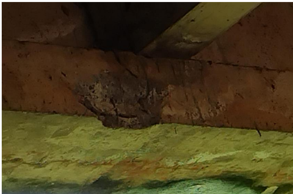
Figura 23 - Relatório 001: Viga longarina 8
