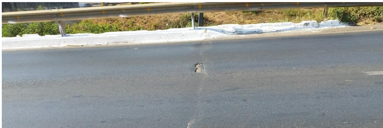
Figura 41 - Relatório 027: Junta de dilatação encoberta por CBUQ com fissura e buraco
