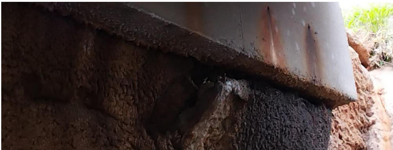
Figura 54 - Relatório 631: Cortina com marcas de infiltração
