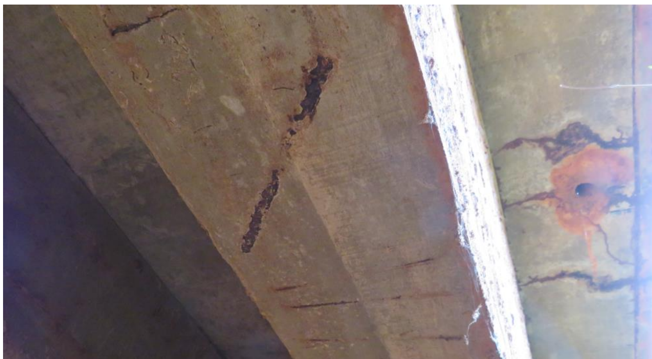
Figura 50 - Relatório 200: Vigas e longarinas com armadura exposta e corroídas com baixo cobrimento
