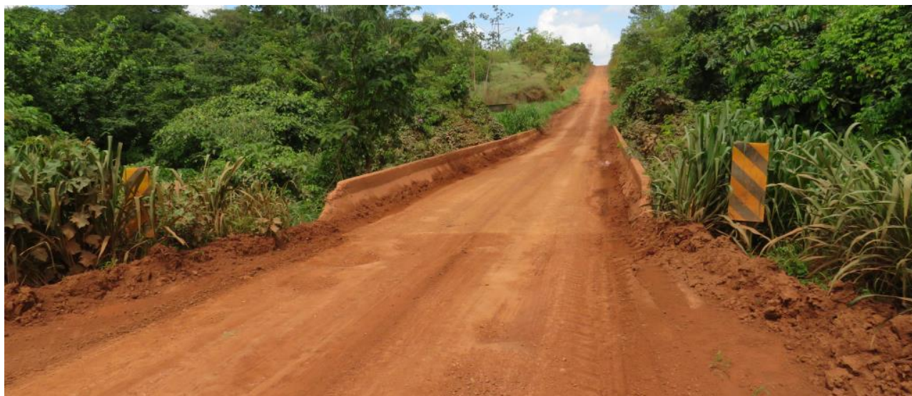
Figura 49 - Relatório 200: Guarda rodas com ausência de dispositivo de sinalização refletiva
