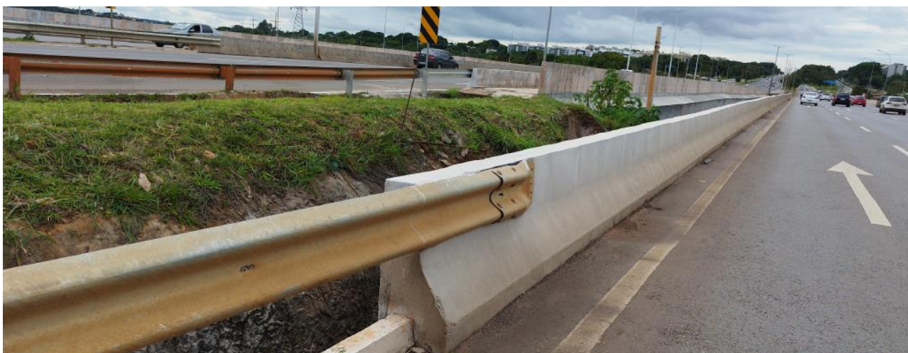
Figura 55 - Relatório 631: Guarda rodas com ausência de dispositivo de sinalização refletiva
