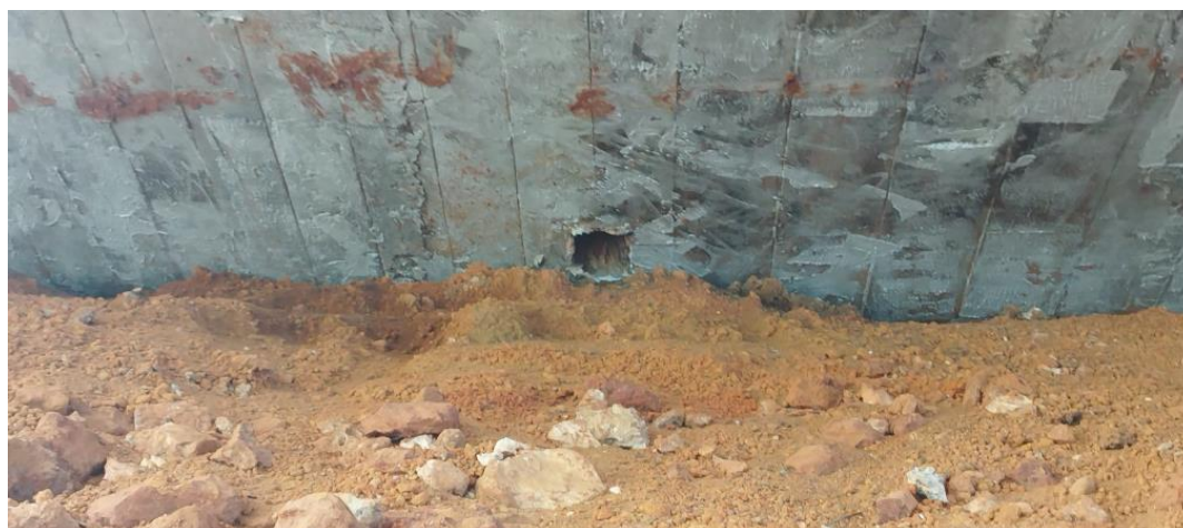
Figura 61 - Relatório 659: Laje com concreto disgregado
