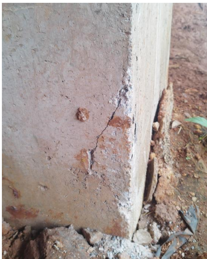
Figura 62 - Relatório 659: Pilar 7 com concreto disgregado
