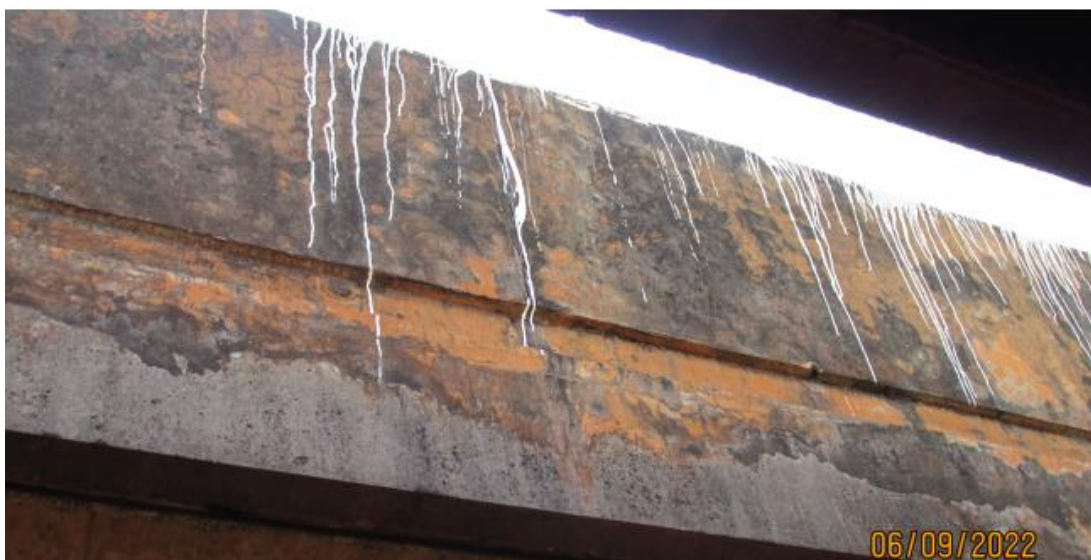
Figura 39 - Relatório 020: Guarda rodas com fissuras
