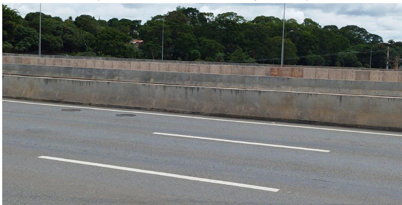
Figura 63 - Relatório 659: Guarda rodas com ausência de dispositivo de sinalização refletiva
