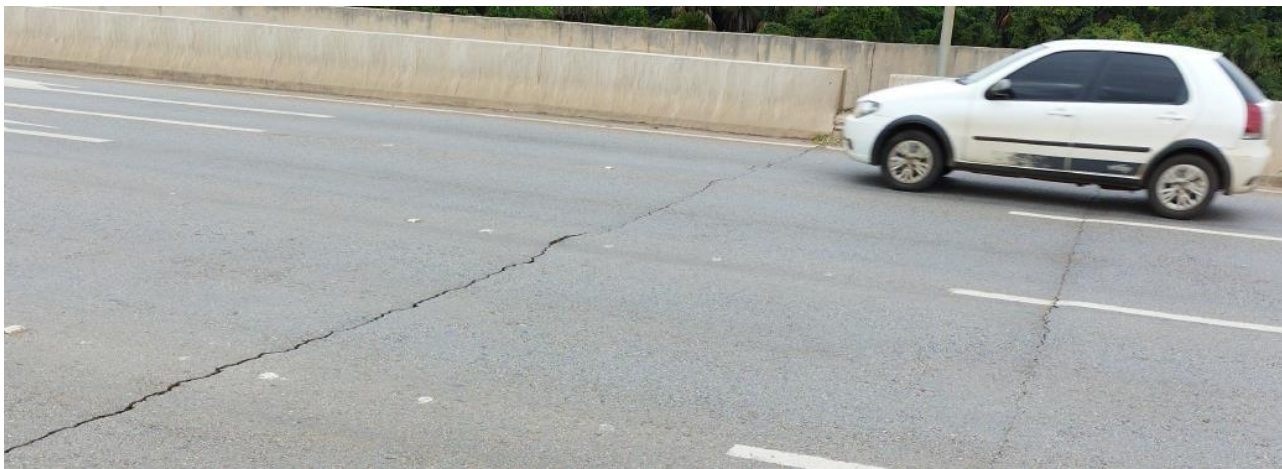
Figura 53 - Relatório 631: Laje da transição com fissuras
