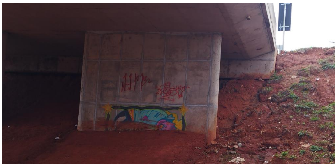
Figura 57 - Relatório 632: Talude com erosão acentuada e ausência de revestimento
