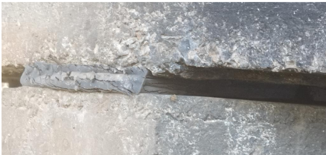
Figura 43 - Relatório 027: Aparelho de apoio fora de posição com rasgos
