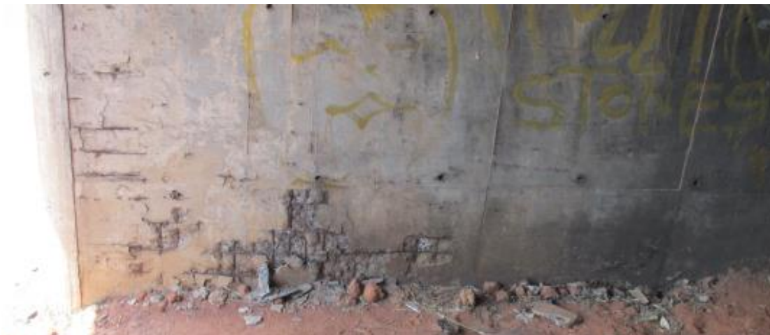
Figura 37 - Relatório 020: pilar com concreto desagregado e armadura exposta e oxidada
