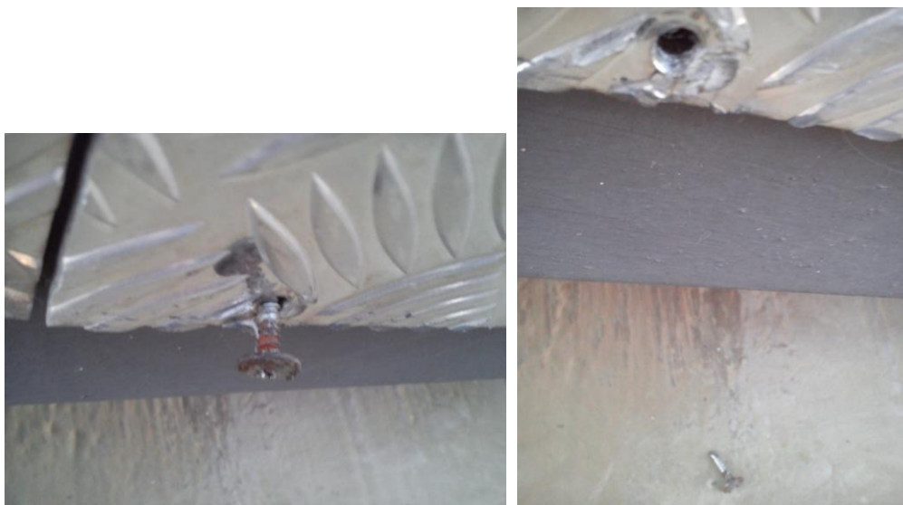
Figuras 14 e 15 - Rebite de fixação das folhas de aço à longarina da rampa de acesso ao heliponto com perda total de função
