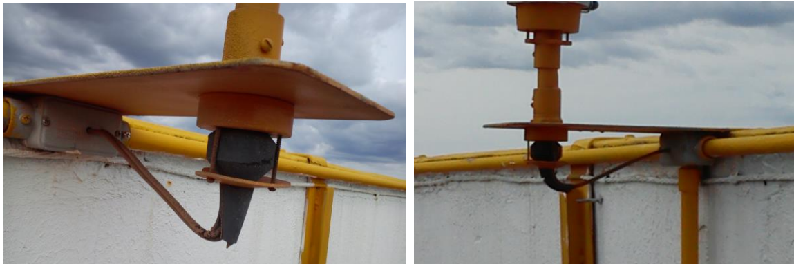
Figuras 21 e 22 - Cabeamentos e bulbos emborrachados de luminárias SN05 ressecados e trincados
