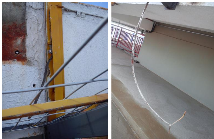
Figuras 23 e 24 - Dois dos quatro locais onde a cordoalha de cobre da Gaiola de Faraday foi rompida por ocasião do deslocamento da rampa de acesso ao heliponto
