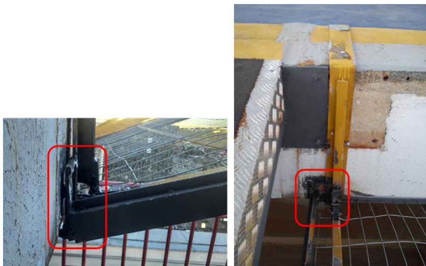
Figuras 10 e 11 - Local do rompimento na fixação da longarina de reforço à plataforma do heliponto e na solda do conjunto
