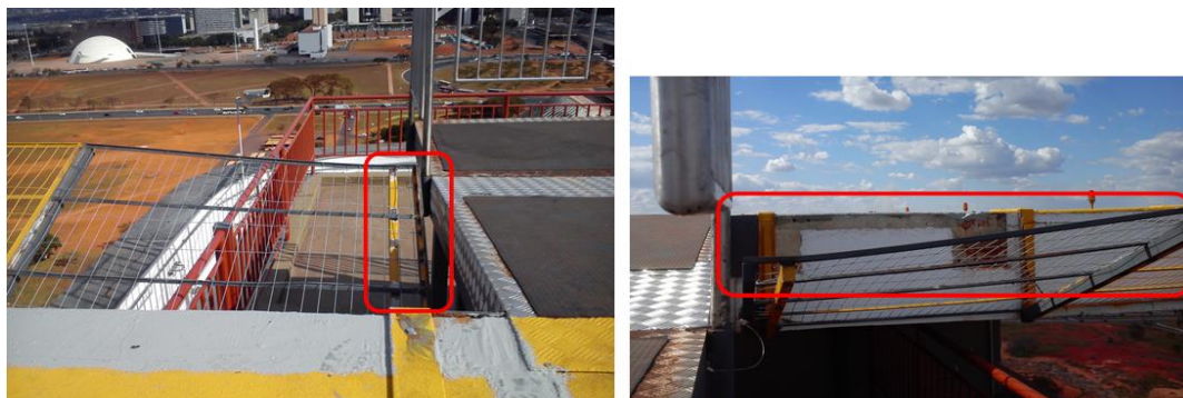
Figura 6: Porção da Grade de Proteção de heliponto à direita de quem sobe a rampa cuja longarina e reforço foram ensaiados e Figura 7: Longarina e reforço deformados após teste de carga (a área em vermelho mostra o desnível das pontas da grade)
