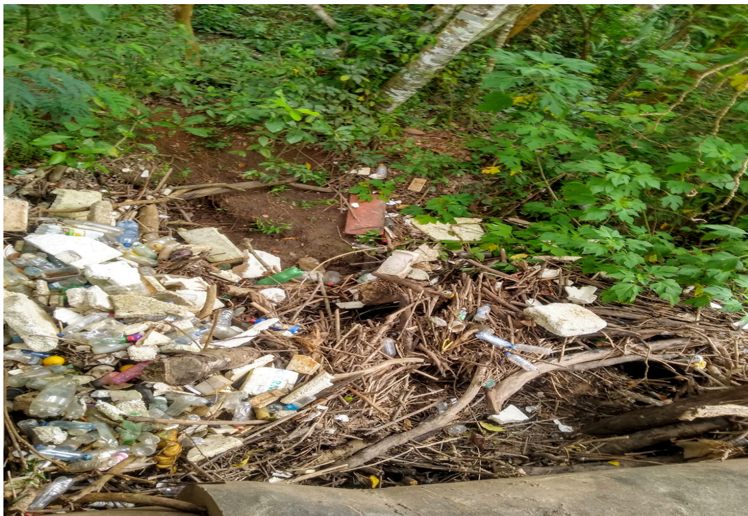
Figura 28- Lixo retido pela manilha que atravessa o Córrego Guar no Ponto de Parada 1
