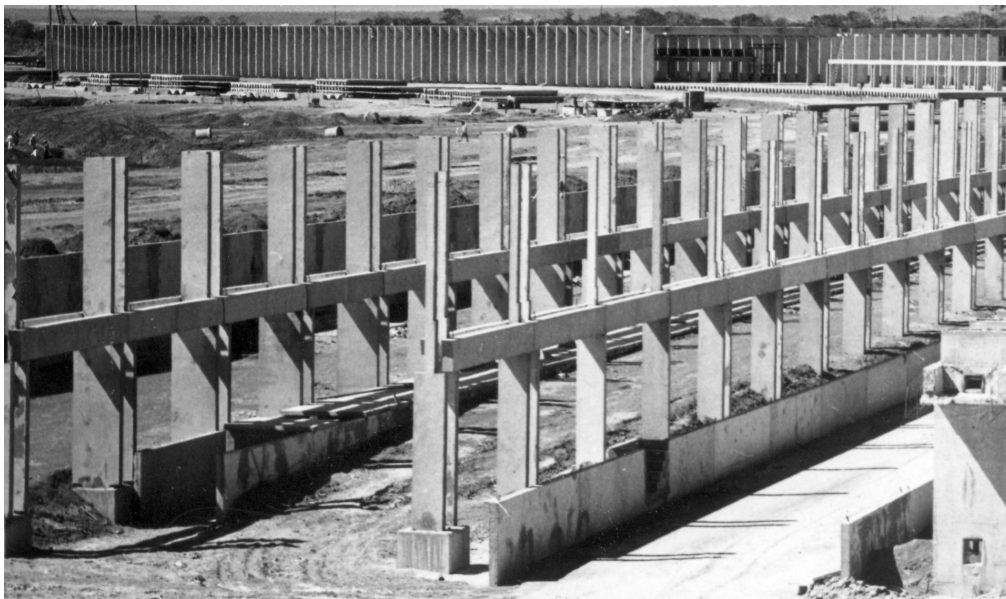
Figura 189: Fotografias da construção do ICC. a. Fundação e subsolo. b. Execução dos pilares. Fonte: Arquivo Central da UnB.
