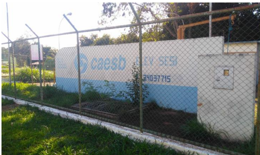
Figura 9 – Elevatória da CAESB
