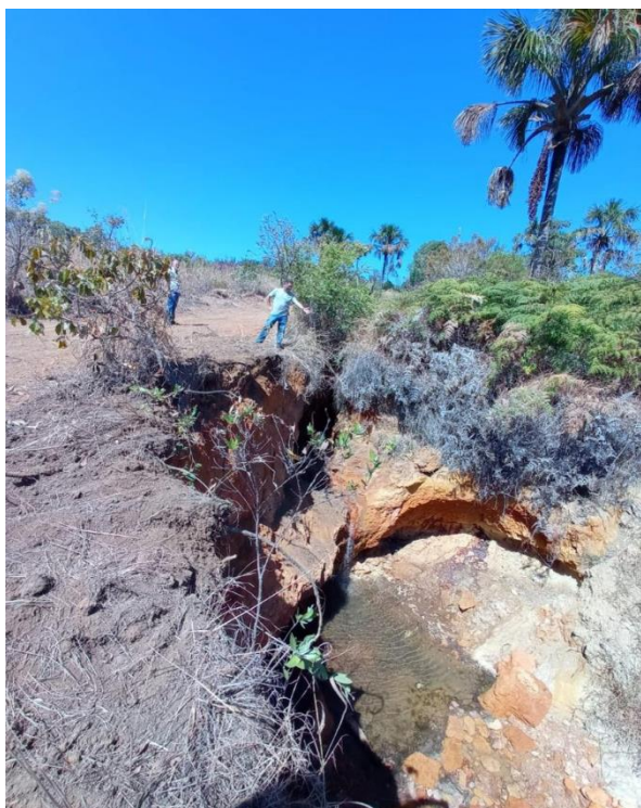
Figura 3 – Erosão a jusante do Condomínio RK, Região dos Lagos em Sobradinho
