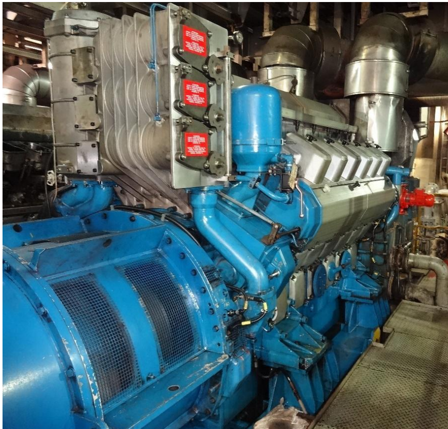
Figura 19: Motor de Combustão Interna Wartsila 12V-W200.
