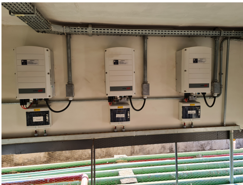
Figura 2.8: Inversores SolarEdge da Usina de Minigeração do Ministério da Defesa.
