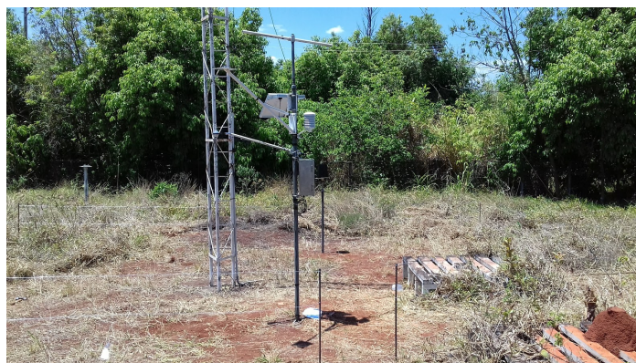
(d) Estação instalada.
