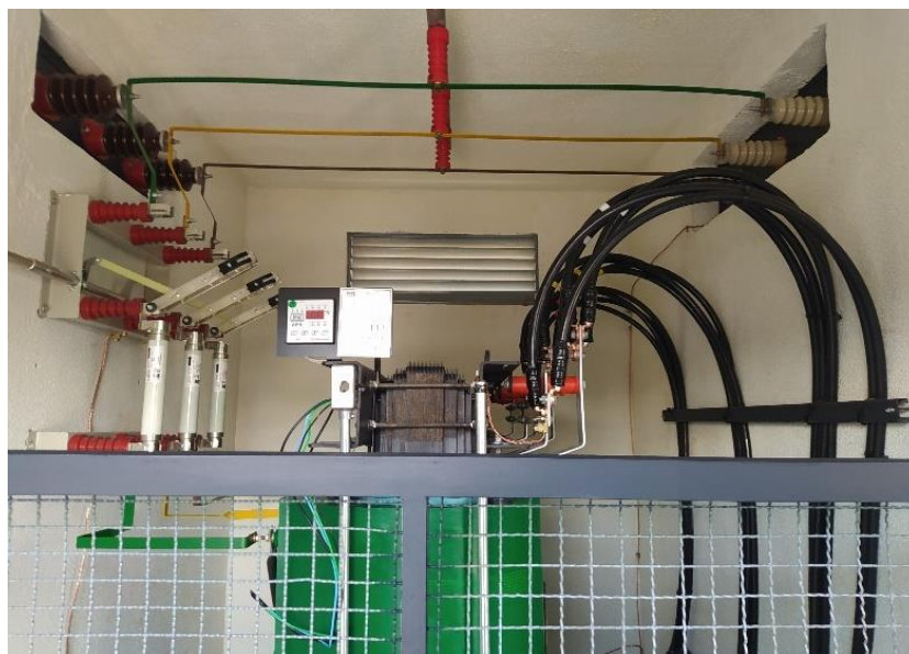
Figura 4.26. Terceiro particionamento - Transformador 2 e seus componentes.
