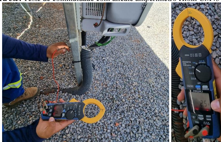
Figura 3.5. Teste de continuidade com alicate amperímetro Hioki CM4373.
