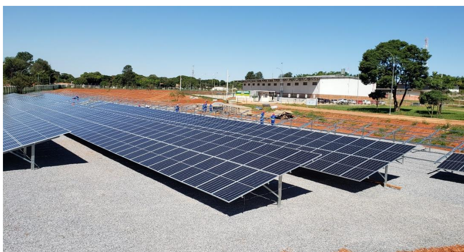
Figura 4.14. Primeiros módulos FV instalados.
