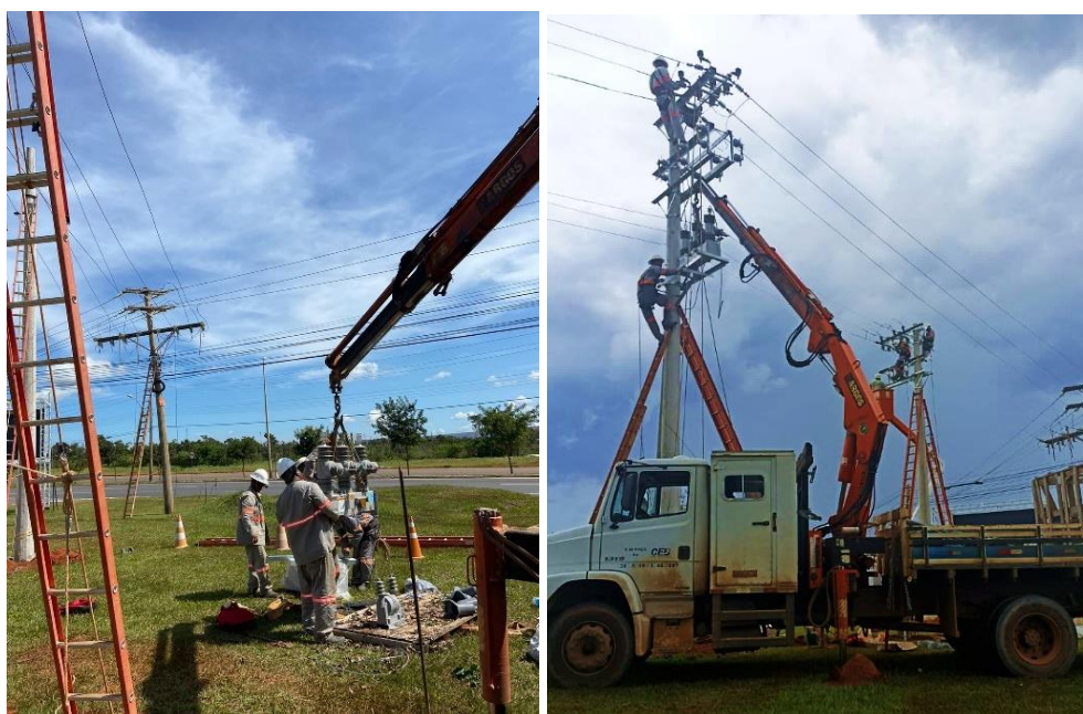
Figura 4.31. Instalação dos religadores automáticos.
