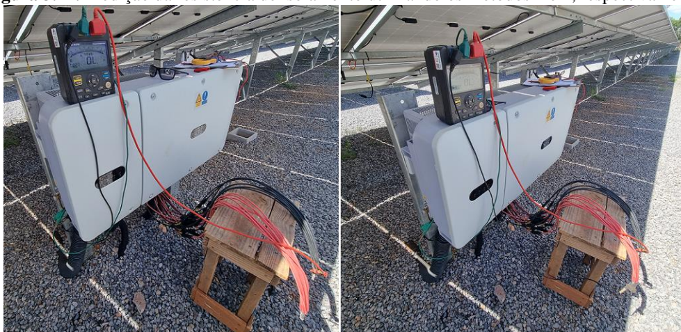
Figura 3.11. Medição da resistência de isolamento utilizando os métodos 1 e 2, respectivamente.
