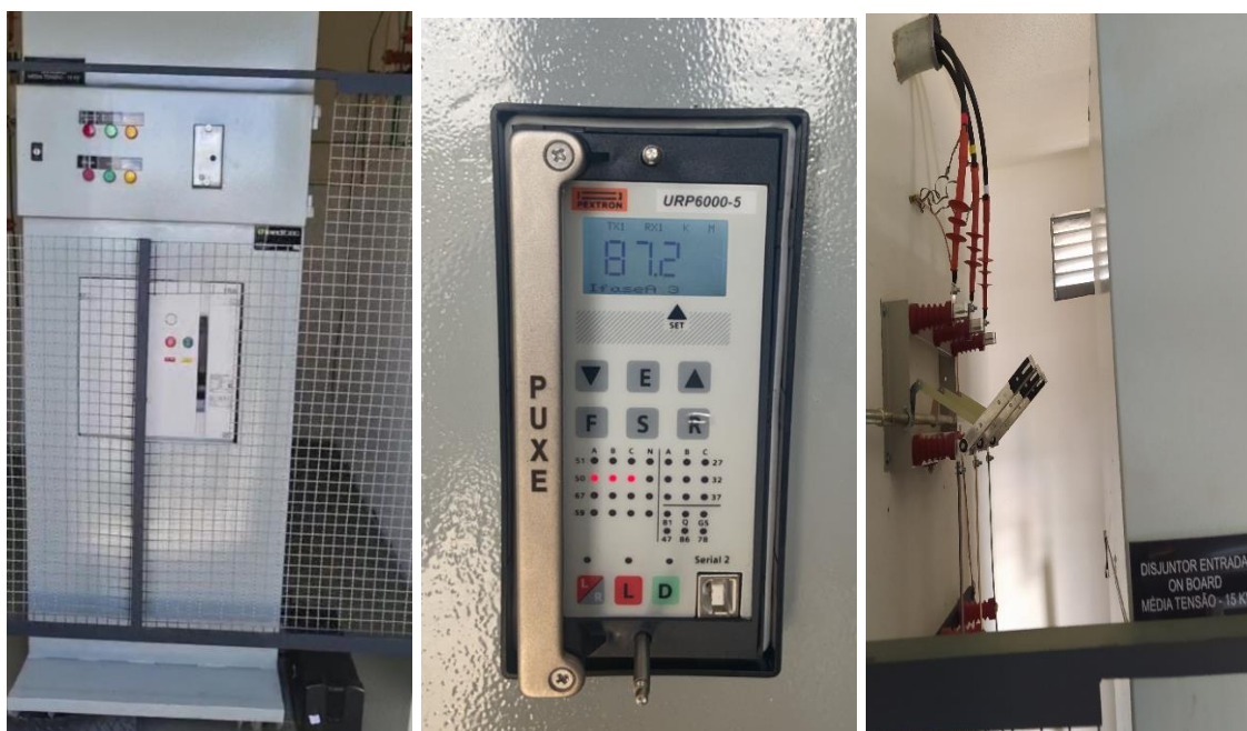
Figura 4.27. Quarto particionamento – Disjuntor de média tensão.
