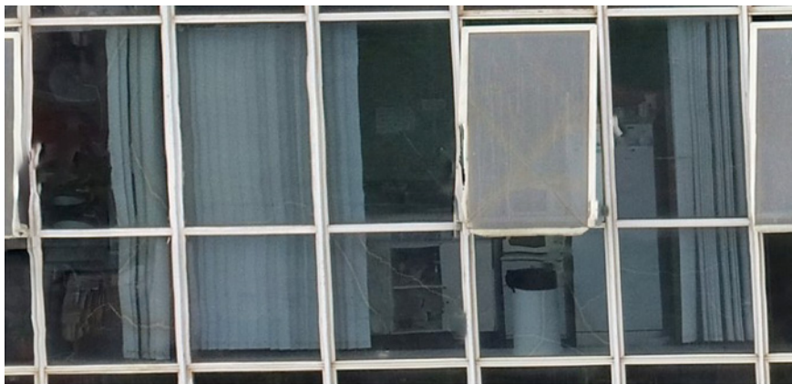
Figura 8.4 – Identificação de vidros quebrados na ortoimagem
