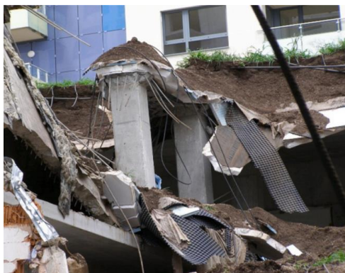
Figura 2.8 – Laje da cobertura colapsada (JAROSLAV et al , 2021)
