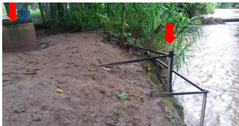
Figura 4.38. Manilha de concreto para proteção do amostrador automático e régua linimétrica.
