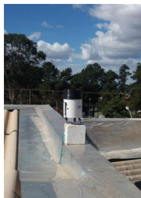
Figura 4.14. Pluviógrafos instalado no CBM na RA RF 1.
