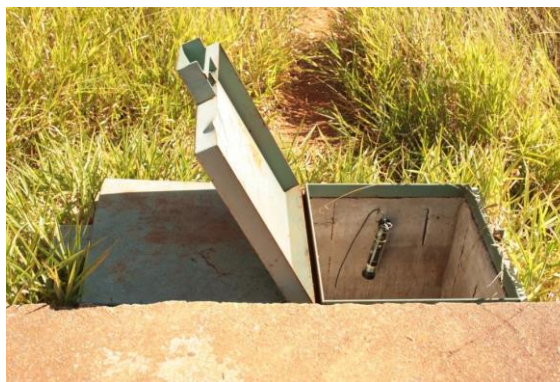
Figura 4.22. Abrigos para o amostrador automático (esquerda) e o linígrafo de boia (direita)
