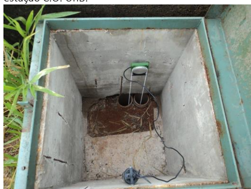
Figura 4.23. Linígrafo de boia e as tubulações para ligação da galeria por meio dos vasos comunicantes.
