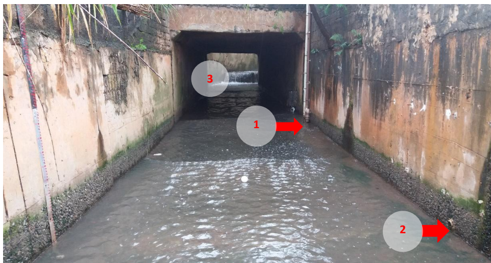
Figura 4.30. Locais na Galeria de drenagem da ETE RF I: 1) Local onde a mangueira do amostrador coletava as amostras na galeria, junto com o detector de nível e ao lado da sonda paramétrica. 2) Conexão do canal com o vaso comunicante construído para abrigar a boia do linígrafo. 3) Degrau imediatamente a montante da estação.
