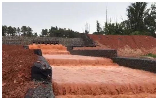
Figura 5.33. Carreamento de sedimentos durante um evento chuvoso ocorrido na obra de uma bacia de detenção.
