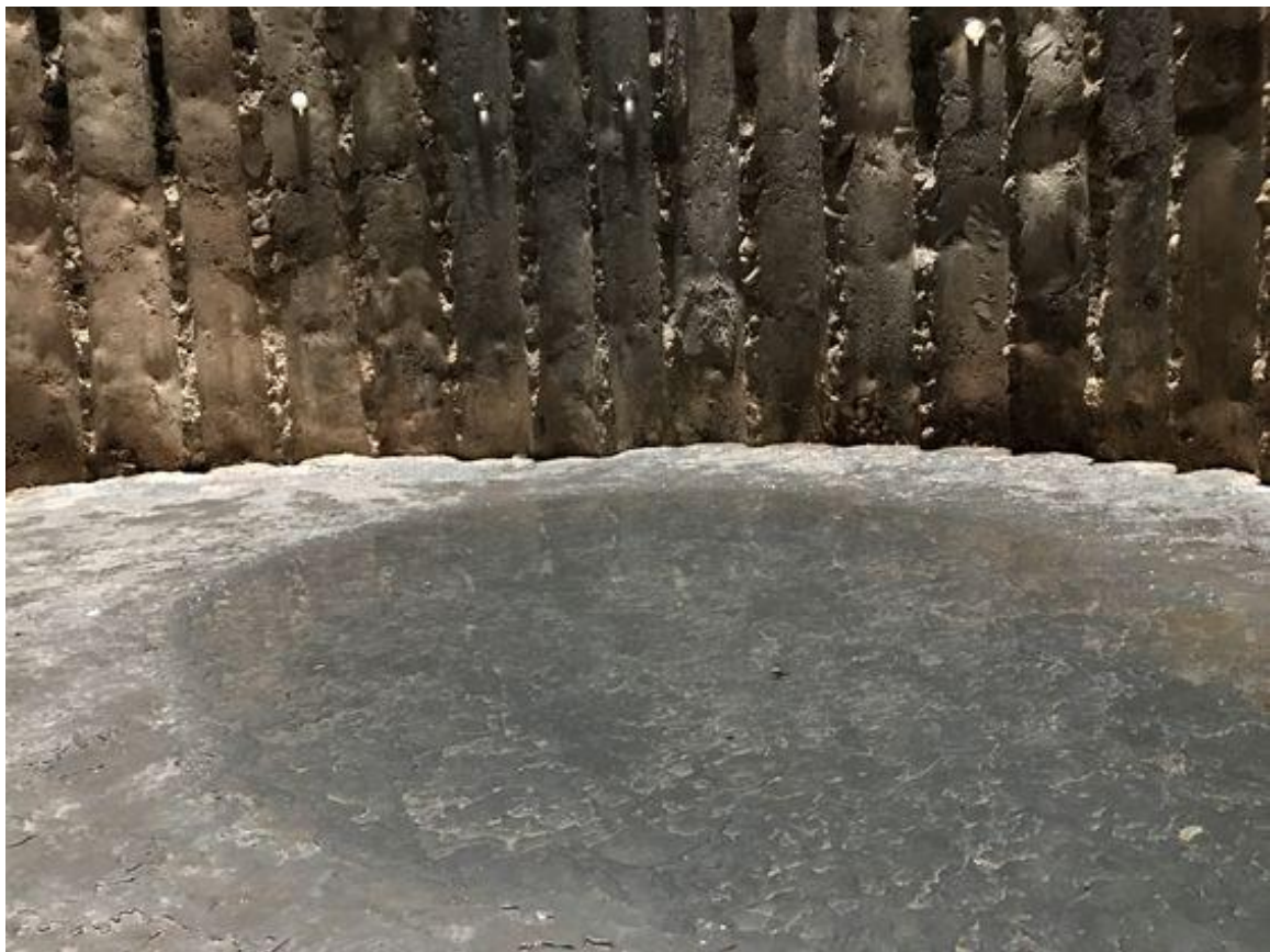
(Acúmulo de água da chuva no piso da Capela)
