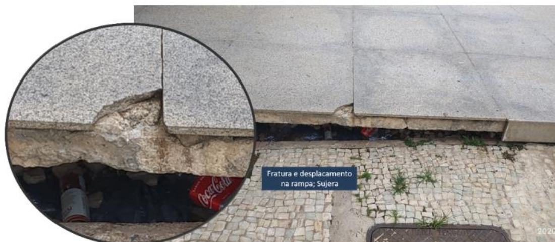
Figura 9 – Fratura e deslocamento na rampa; Sujera
