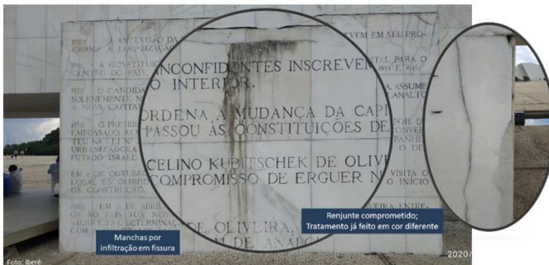
Figura 8 – Manchas por infiltração em fissura
